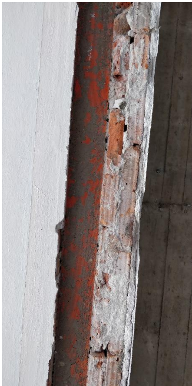
Foto 65: Onderkant van de balk.
