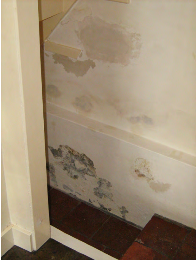
Optrekkend vocht door een hoge grondwaterstand. Foto: bewoner binnenstad
