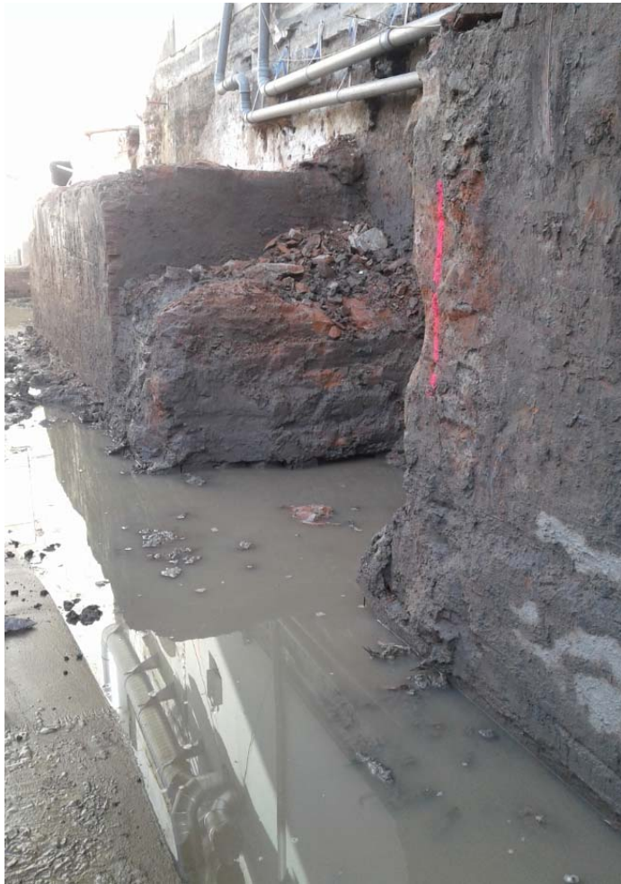
Vrij gegraven stook buiten kelder t.b.v. plaatsen damwand strook aan noordzijde t.b.v uitkeuring ontgraving sterk verontreinigde grond (voor zover aanwezig tussen puin en funderingen)
