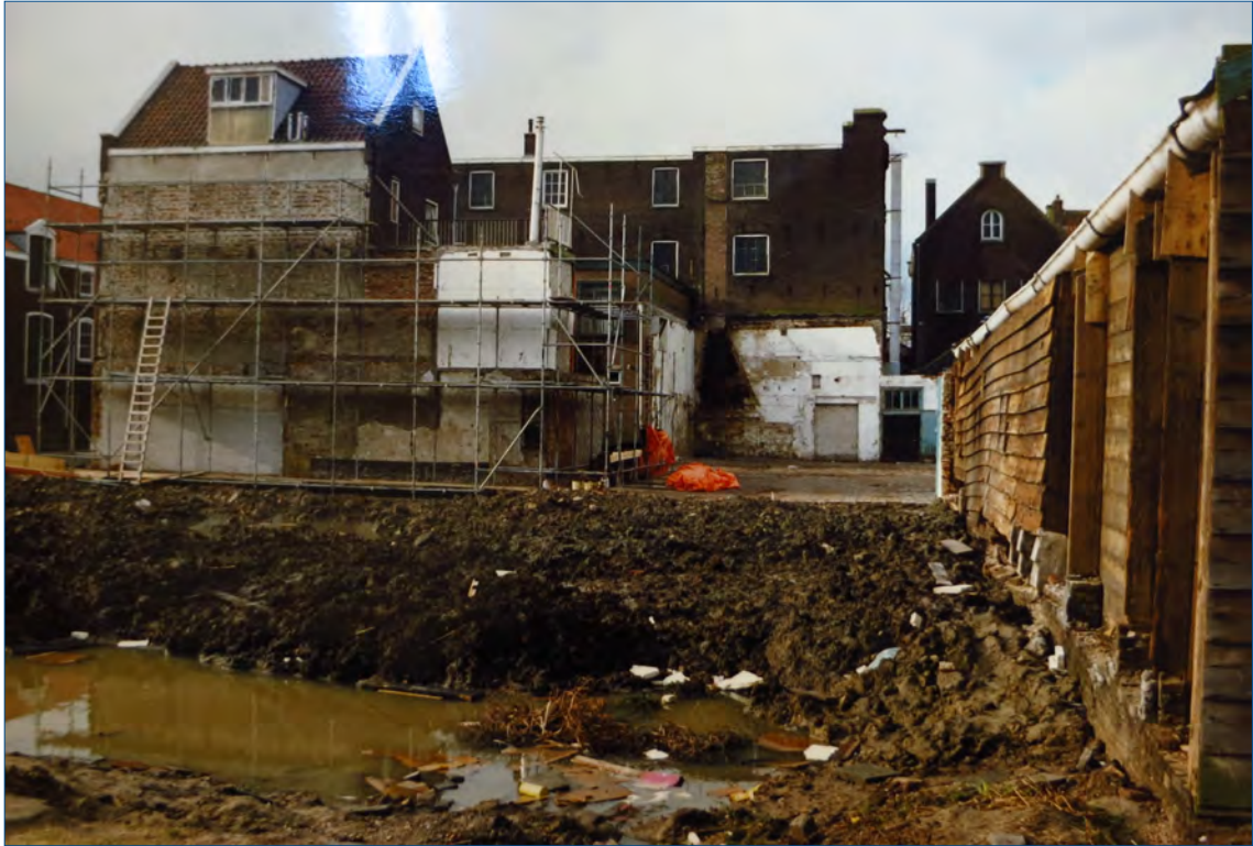
Figuur 10. Een foto uit 1988 van een ontgraving in het zuidelijk deel van het plangebied (bron: stadsarchief Vlaardingen).
