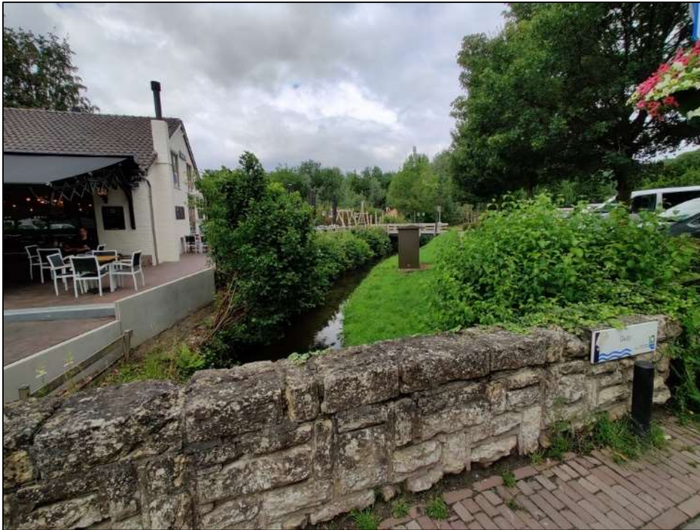
Figuur 9: Het tracé van de Gulp tussen de voorde en de Dorpsstraat waar steenbestorting en stapelmuren worden aangebracht.
