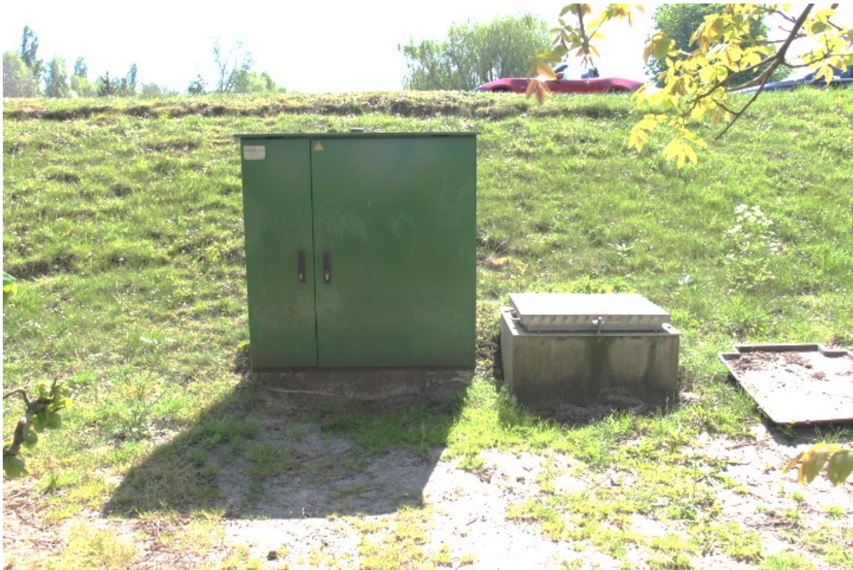
Gemaal met schakelkast (links) en pompput (rechts)
