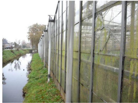
Foto 28. Asbesthoudende kaskit op gevel (bron Bron8)
