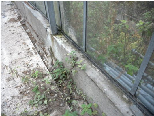
Foto 5. Asbesthoudende kaskit op voetrans (bron Bron3)
