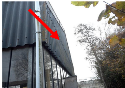
FOTO 4 | Golfplaat tegen gevel
