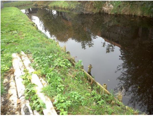
Foto 43. Asbesthoudende beschoeiing (bron Bron12)
