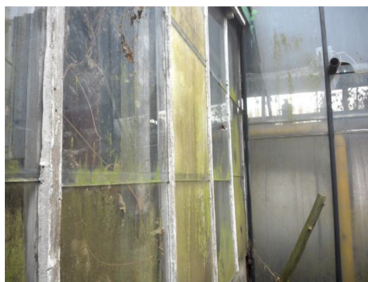
Foto 38. Asbesthoudende beglazingskit (bron Bron11)
