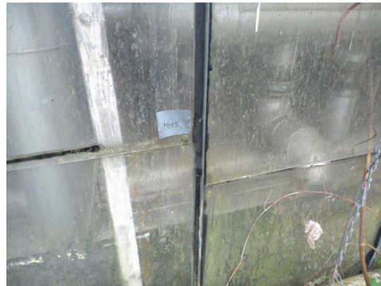
Foto 30. Asbesthoudende kaskit op gevel (bron Bron8)
