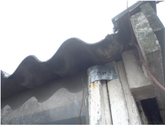
Foto 31. Asbesthoudende golfplaat inclusief hulpstukken (bron Bron9)
