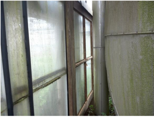
Foto 49. Asbesthoudende beglazingskit (bron Bron13)
