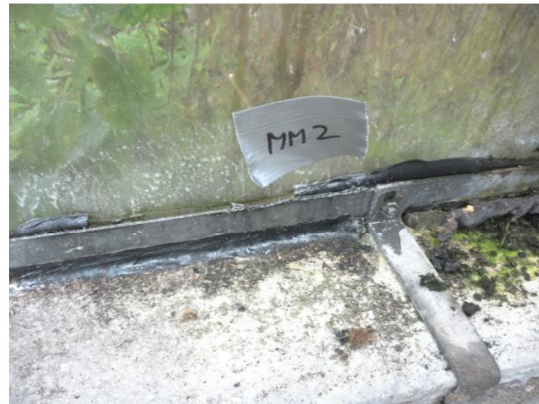
Foto 6. Asbesthoudende kaskit op voetrans (bron Bron3)
