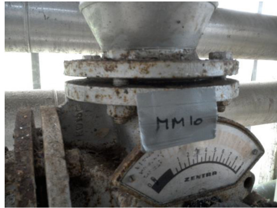
Foto 52. Asbesthoudende flenspakking (bron Bron14)
