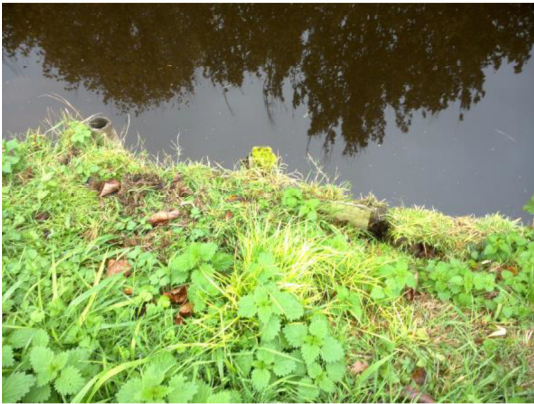
Foto 45. Asbesthoudende beschoeiing (bron Bron12)
