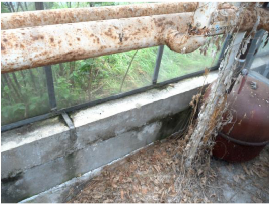
Foto 9. Asbesthoudende kaskit op voetrand (bron Bron3)
