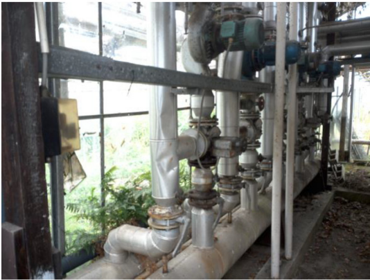
Foto 51. Asbesthoudende flenspakking (bron Bron14)
