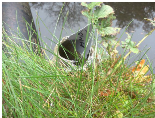
Foto 40. Asbesthoudende beschoeiing (bron Bron12)
