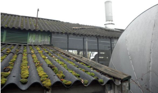
Foto 33. Asbesthoudende golfplaat inclusief hulpstukken (bron Bron9)
