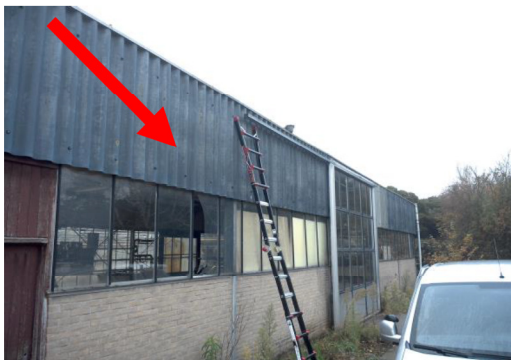
FOTO 3 | Golfplaat tegen gevel
