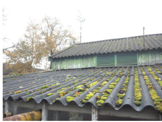
Foto 32. Asbesthoudende golfplaat inclusief hulpstukken (bron Bron9)
