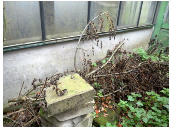
Foto 36. Asbesthoudende plaatmateriaal (bron Bron10)
