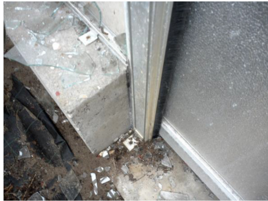
Foto 10. Asbesthoudende kaskit op voetrand (bron Bron3)
