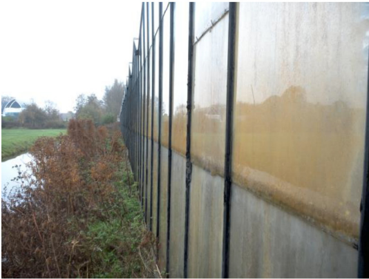
Foto 15. Asbesthoudende kaskit op gevel (bron Bron4)
