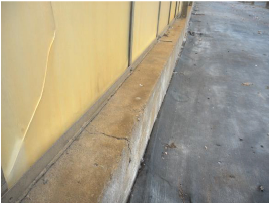
Foto 7. Asbesthoudende kaskit op voetrand (bron Bron3)
