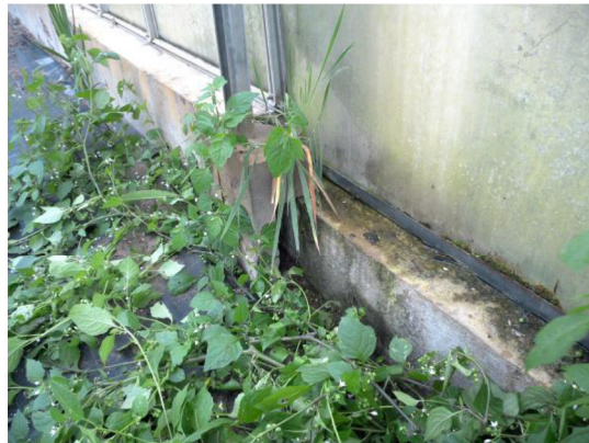
Foto 12. Asbesthoudende kaskit op voetrand (bron Bron3)
