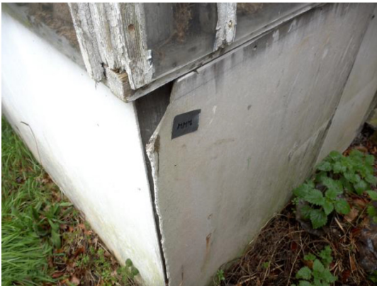
Foto 35. Asbesthoudende plaatmateriaal (bron Bron10)
