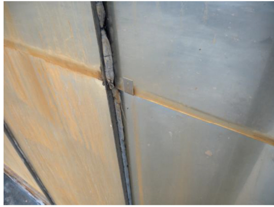
Foto 14. Asbesthoudende kaskit op gevel (bron Bron4)
