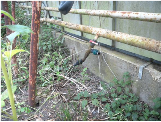
Foto 25. Asbesthoudende kaskit op voetrand (bron Bron7)
