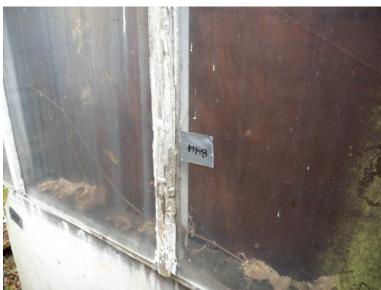
Foto 37. Asbesthoudende beglazingskit (bron Bron11)
