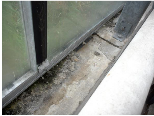
Foto 8. Asbesthoudende kaskit op voetrand (bron Bron3)
