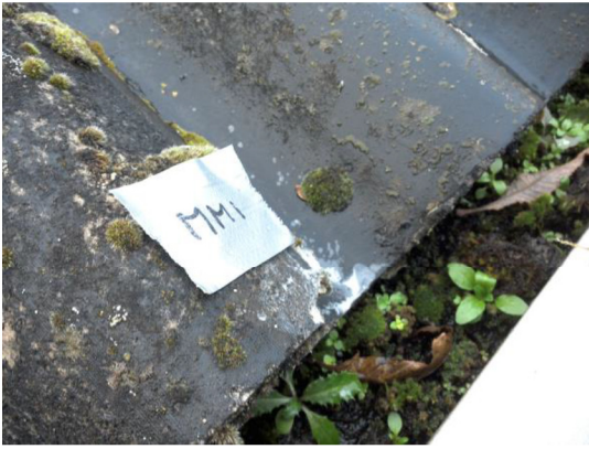
Foto 1. Asbesthoudende golfplaat inclusief hulpstukken (bron Bron1)
