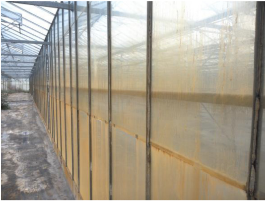
Foto 13. Asbesthoudende kaskit op gevel (bron Bron4)
