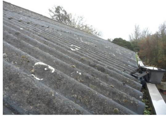
Foto 2. Asbesthoudende golfplaat inclusief hulpstukken (bron Bron1)
