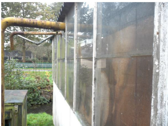
Foto 39. Asbesthoudende beglazingskit (bron Bron11)
