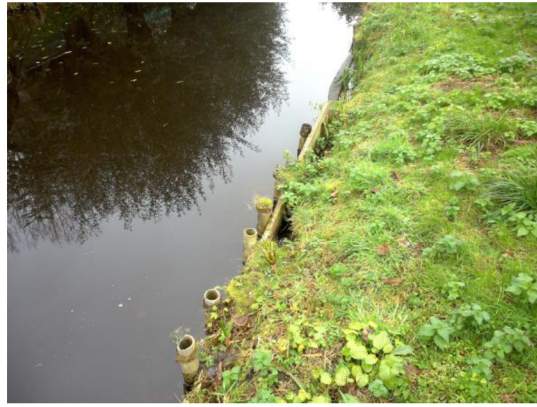
Foto 44. Asbesthoudende beschoeiing (bron Bron12)
