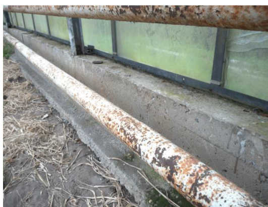
Foto 24. Asbesthoudende kaskit op voetrand (bron Bron7)
