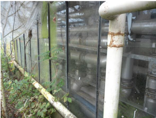
Foto 29. Asbesthoudende kaskit op gevel (bron Bron8)
