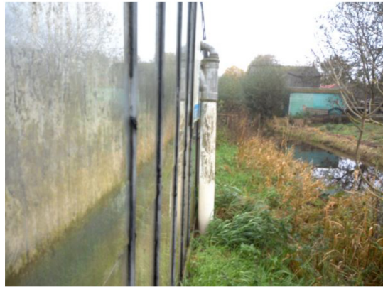
Foto 16. Asbesthoudende kaskit op gevel (bron Bron4)
