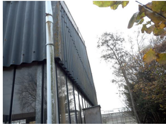
Foto 4. Asbesthoudende golfplaat tegen gevel (bron Bron2)
