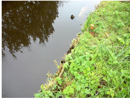
Foto 46. Asbesthoudende beschoeiing (bron Bron12)
