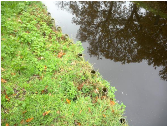
Foto 47. Asbesthoudende beschoeiing (bron Bron12)
