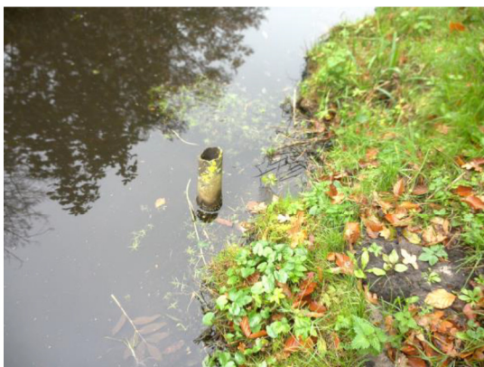
Foto 41. Asbesthoudende beschoeiing (bron Bron12)
