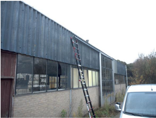
Foto 3. Asbesthoudende golfplaat tegen gevel (bron Bron2)
