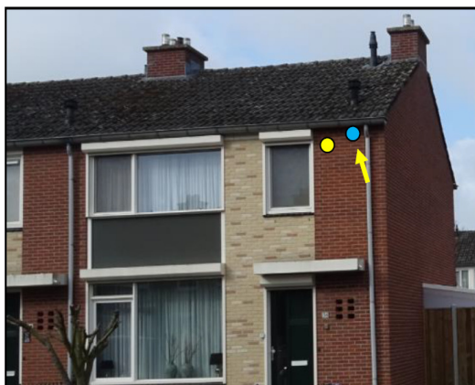
Figuur 6. Locatie inbouwvoorziening in nieuw te realiseren overstek, nabij de oorspronkelijke nestlocatie.
