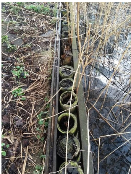
Walbeschoeiing is verrot en zal worden vervangen.
