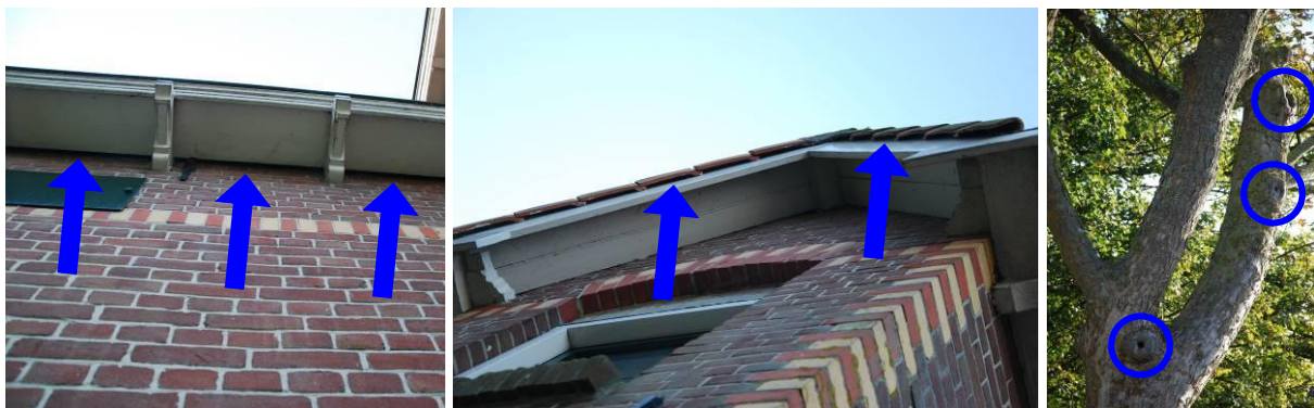
Figuur 5.2. V.l.n.r.: ruimte tussen de muur en het dakoverstek. Ruimte achter de overhangende dakpannen. Holtes in de esdoorn welke momenteel niet ingerot zijn en daarom niet geschikt zijn voor vleermuizen.
