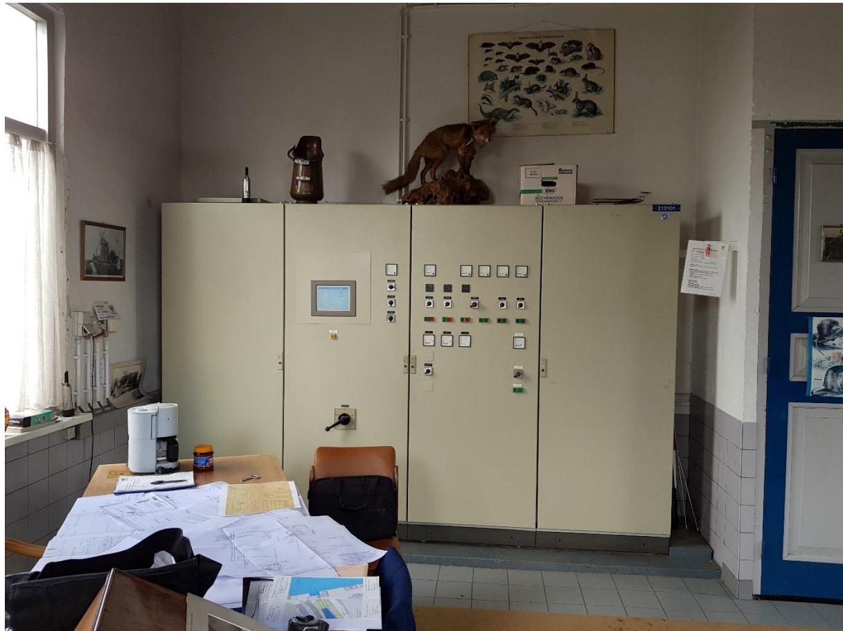
Opstelling bestaande besturingskasten
