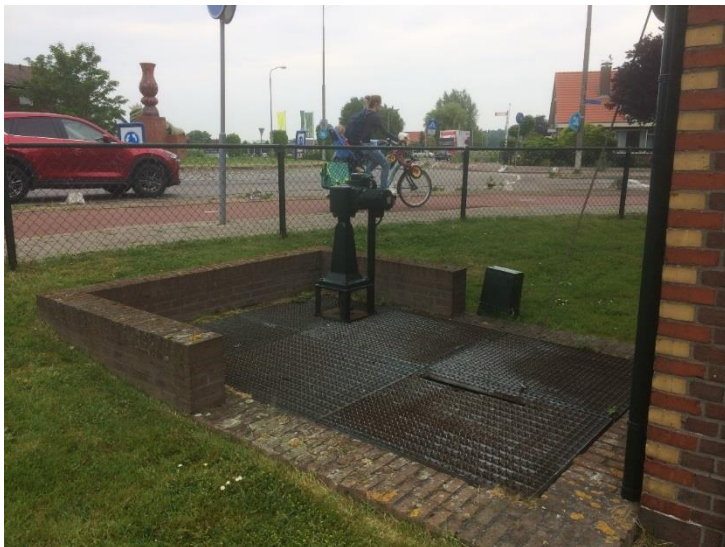
Bestaande uitstroomput met afsluiter en afdekking
