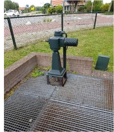
Wandafsluiter boezemzijde inlaat
