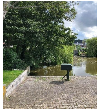
Vlinderafsluiter polderzijde inlaat
