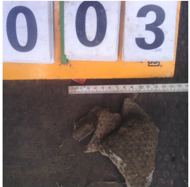
Asbestverdacht materiaal sleuf 03
