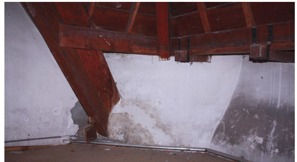
De onderzijde van de hoekkeper van de kap boven de middenrisaliet is in het muurwerk van de hoektoren opgenomen.
