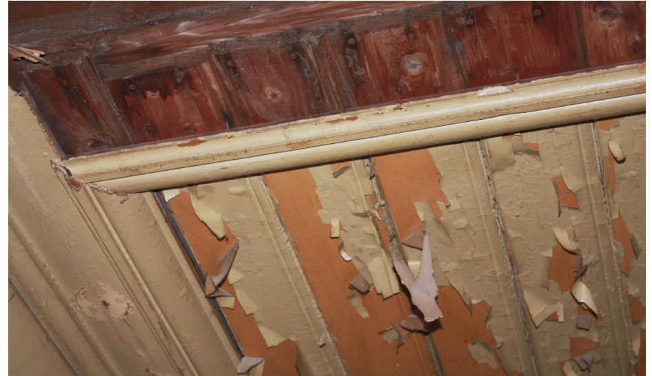
De oorspronkelijke okergele kleurafwerking van de betimmering boven de verdiepingen van de achtervleugels is zichtbaar onder de afbladerende crèmekleur.
