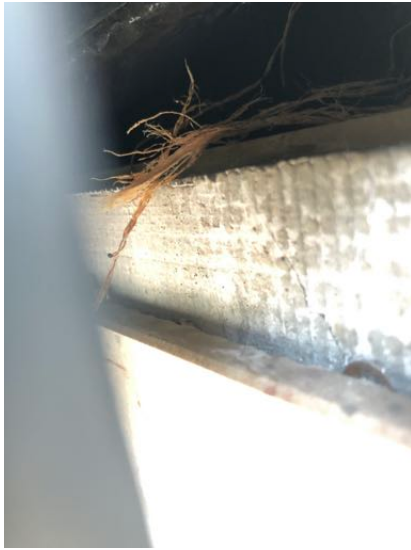
Oud nestmateriaal onder een vensterbank.
