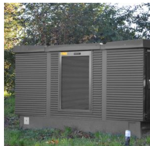
Afb. 34 Voorbeeld van transformatoren (kleur: flessengroen).
