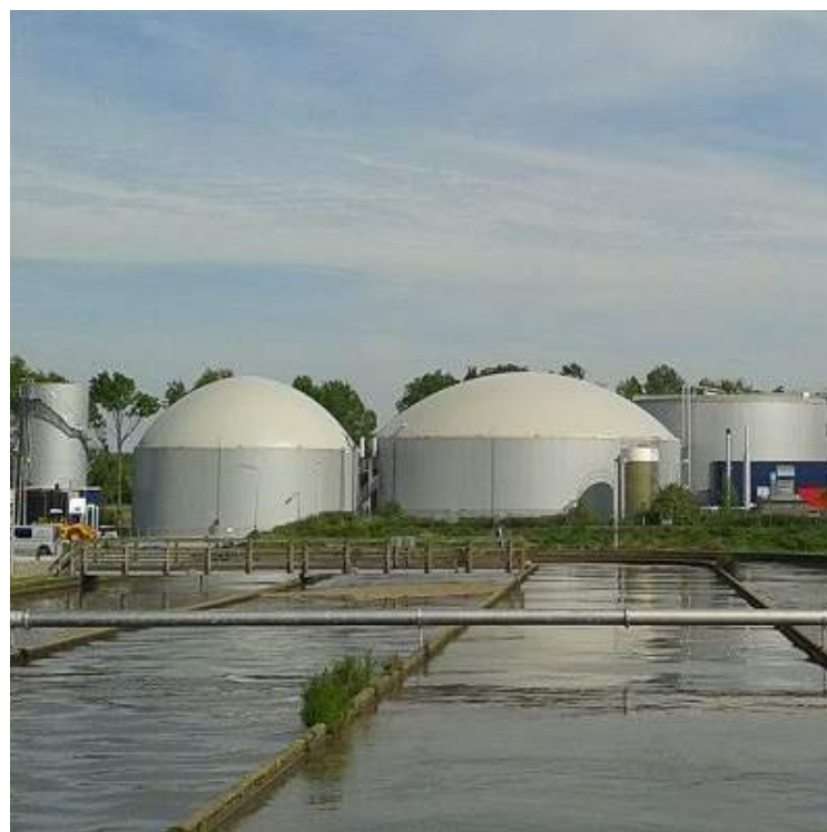
Biogasinstallatie gekoppeld aan RWZI.
