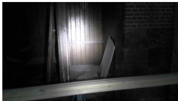
Losse beplating in biechtruimte
