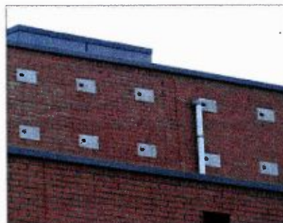
IB GZ 01 kasten ingemetseld in de gevel
