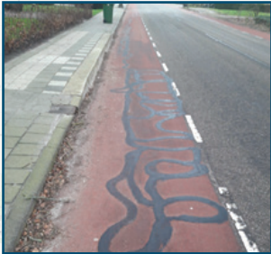
Voorbeeld van kleine reparatie, scheuren
