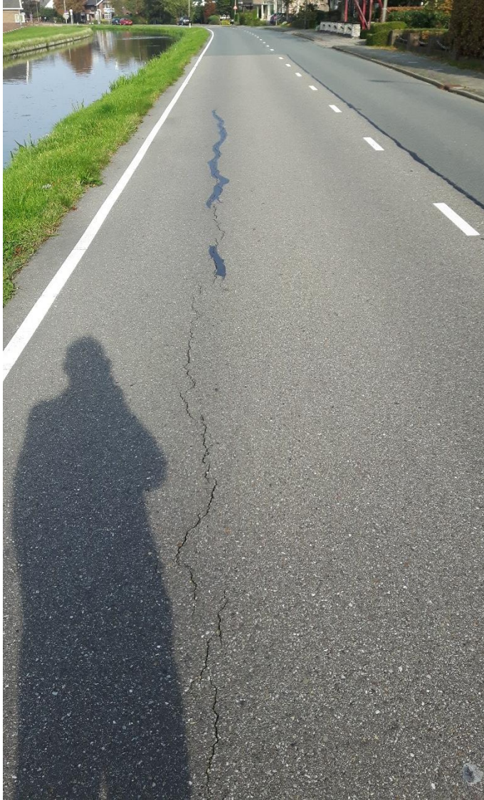
Figuur B1 2 Matige scheurvorming tussen vak 4 en 5
