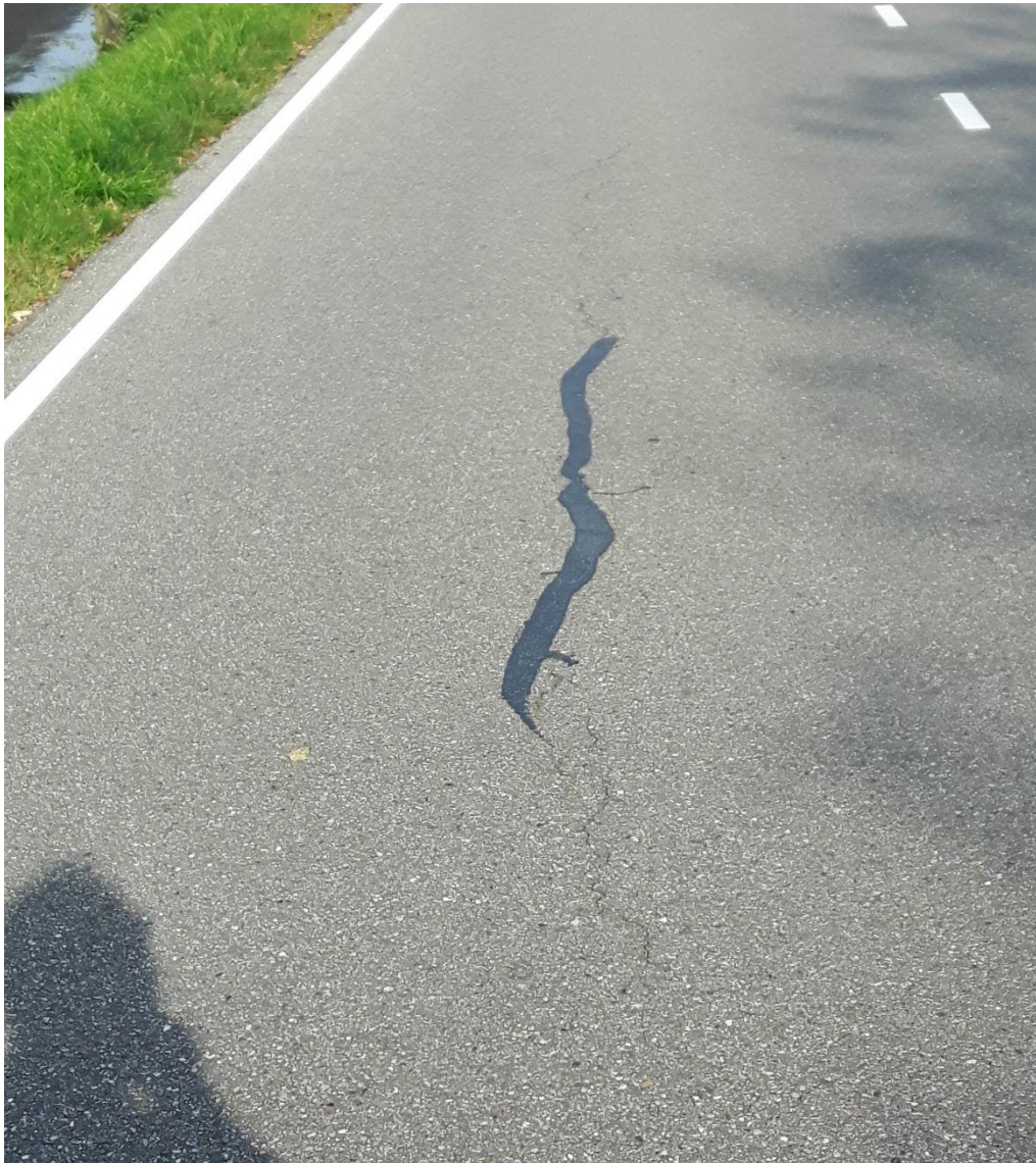
Figuur B1 1 Incidentele (gevulde) langsscheuren in vak 4
