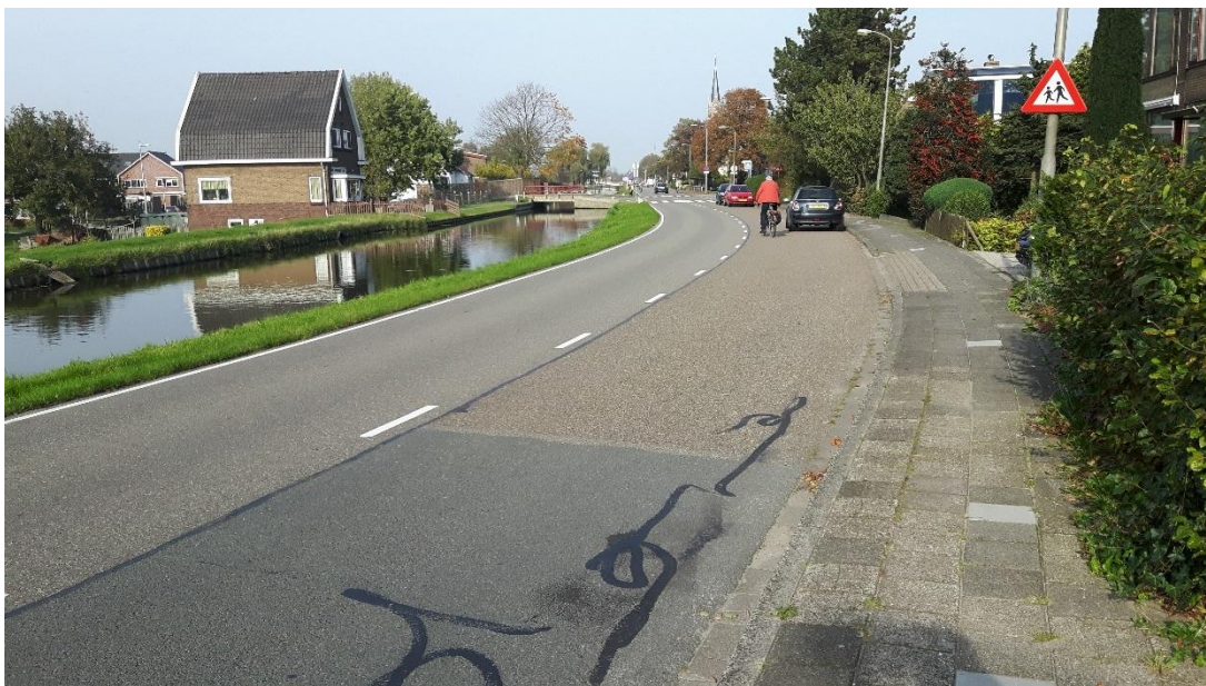
Figuur B1 4 Afwijkende deklaag rechts aan het begin van vak 5.
