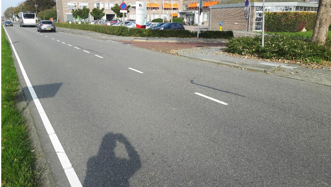
Figuur B1 3 Incidentele (gevulde) langsscheuren in vak 5.
