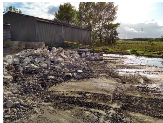
Foto 60: Algemeen tijdens NO asbest 1
