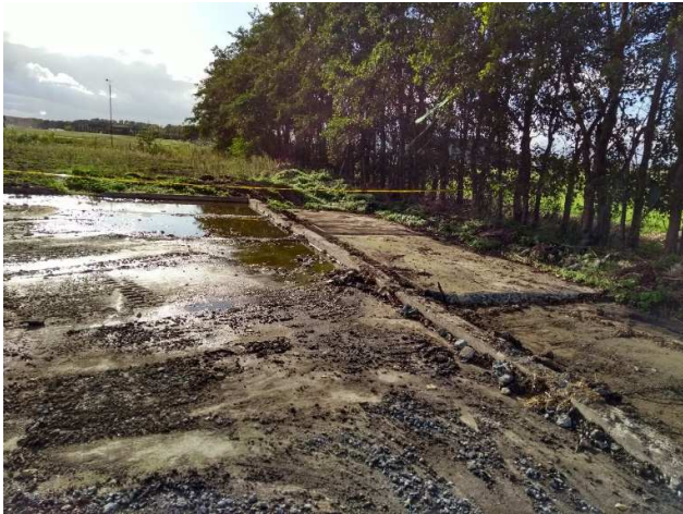
Foto 61: Algemeen tijdens NO asbest 2
