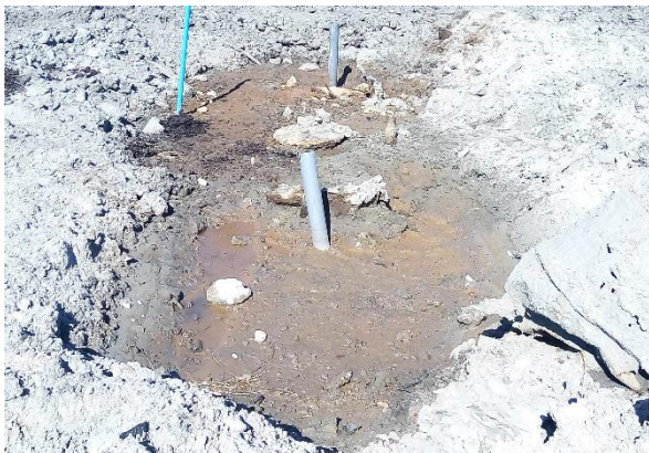
Foto 5: Aangetroffen oude tank onder het pand; peilbuis 510 zichtbaar.
