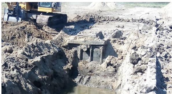
Foto 7: Aangetroffen nog te verwijderen oliewaterafscheider
