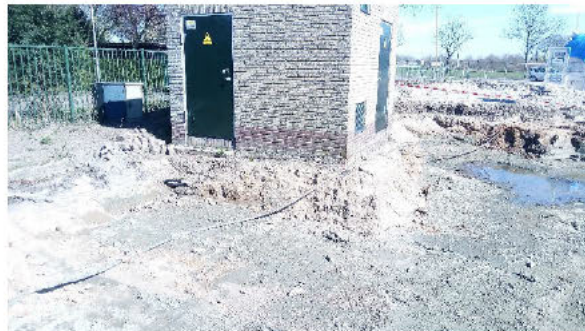
Foto 2: Achtergebleven wand onder trafo met lichte restverontreiniging.
