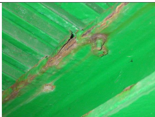
Detailfoto 7: Conserveringsafname en corrosie
