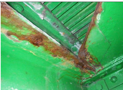
Detailfoto 6: Conserveringsschade en corrosie LL verstijvingsschot
