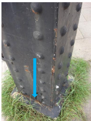
Foto 44: voet lantaarn (aanslag. gecorrodeerd). verfsysteem is matig.
