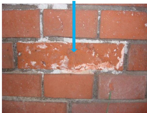
Foto 23: beschadiging steenoppervlak a.g.v. zoutuitbloei.
