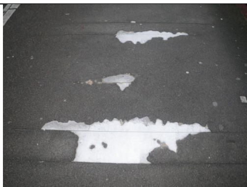
Detailfoto 22: Ontbrekende slijtlaag voetpad rechts
