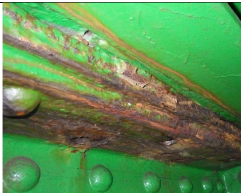
Detailfoto 15: Conserveringsafname, corrosie en lichte materiaalafname
