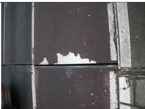
Detailfoto 21: Ontbrekende slijtlaag fietspad achterhar rechts
