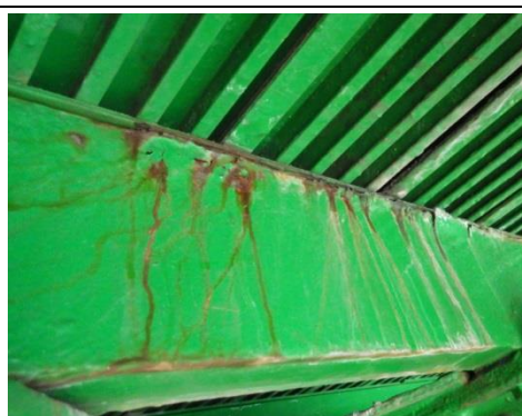
Detailfoto 9: Conserveringsafname en corrosie
