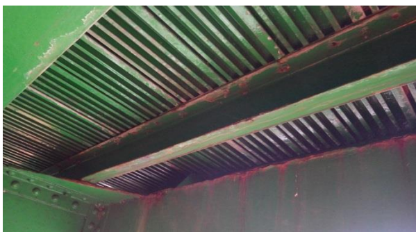
Detailfoto 10: Conserveringsafname en corrosie
