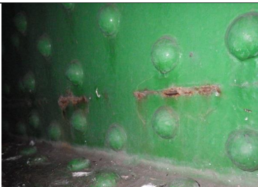
Detailfoto 16: Conserveringsafname en corrosie profielnaad langsligger
