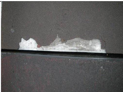
Detailfoto 17: Ontbrekende slijtlaag fietspad links
