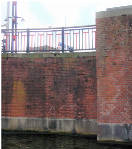
Foto 36: geheel matig tot slecht. Voegwerk metselwerk
