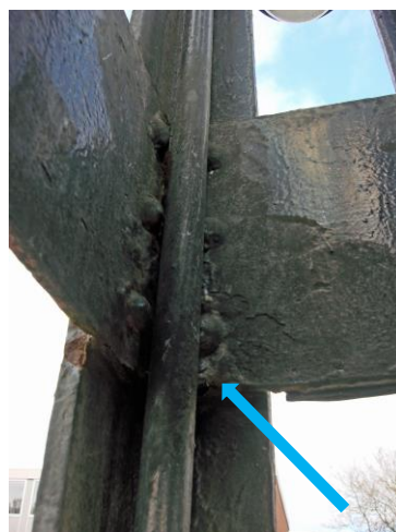
Foto 45: koppelplaat lantaarn. (aansluitingen gecorrodeerd). verfsysteem is matig.
