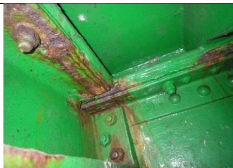
Detailfoto 13: Conserveringsafname en corrosie
