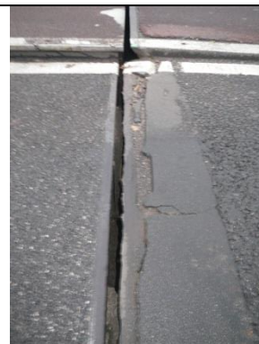
Detailfoto 20: Schade voegovergang voorhar
