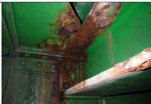
Detailfoto 12: Conserveringsafname en corrosie
