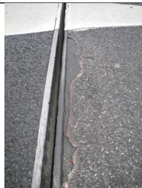
Detailfoto 18: Ontbrekende slijtlaag wegdek
