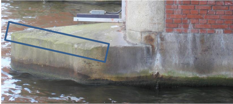
Foto 31 aanvaarschade schampblok pijlerkop.
