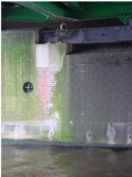
Foto 27: algen en roetvervuiling.
