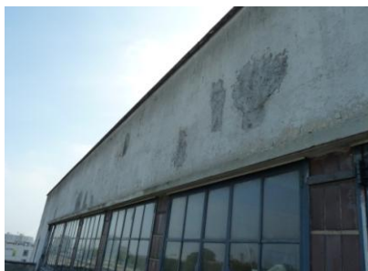
voorbeeld oude reparaties
