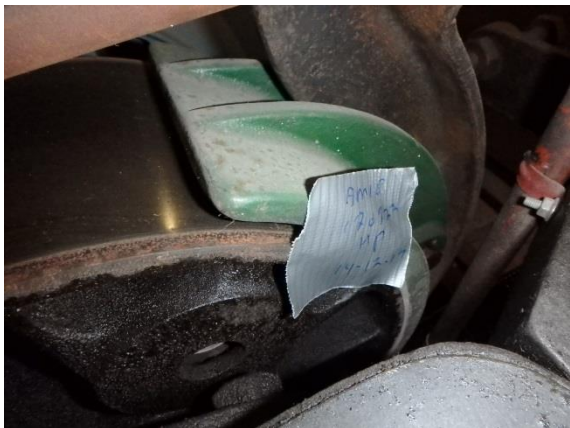
Foto 1: liftmachinekamer een remvoering asbestvrij op 6 e verdieping
