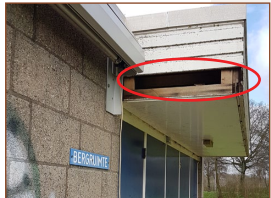
Afbeelding 7: Eén van de openingen in de afdakjes waardoor vogels en andere dieren toegang tot de holle ruimte hebben.
