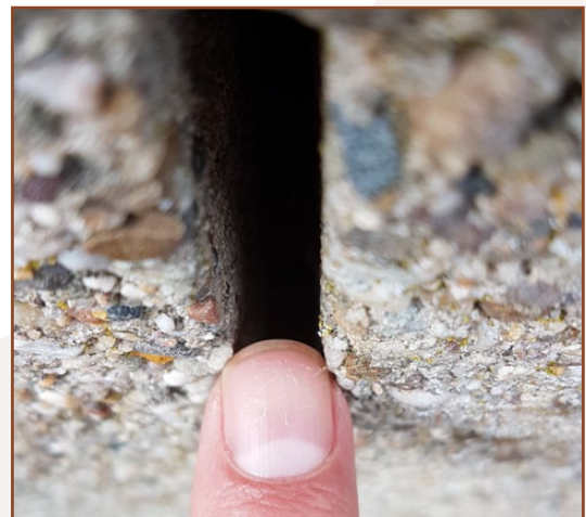
Afbeelding 9: Cloese-up van één van de open voegen. Via de voegen kan de achterliggende luchtspouw bereikt worden.
