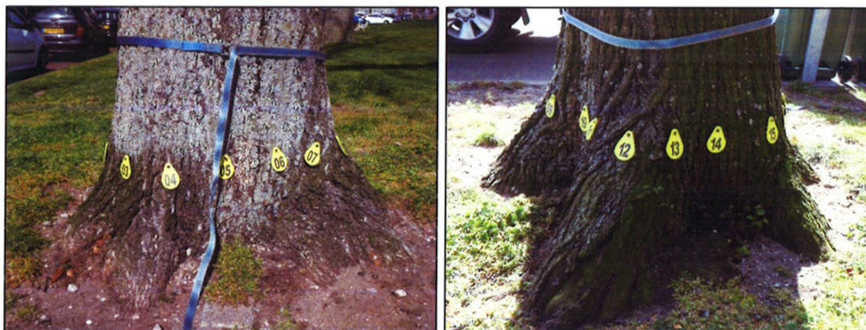
Foto 14: Links en rechts een beeld van de stamvoet met meetpunten. De klankafwijking van de stam bevindt zich tussen meetpunt 5-6 en bij meetpunt 10.
