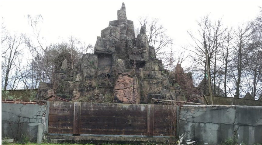
Figuur 2 Bergdierenrots bij inspectie op 28-01-2020
