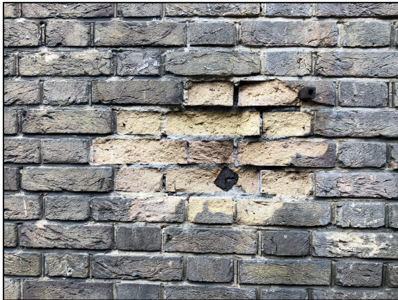
Beschadigd metselwerk achtermuur
