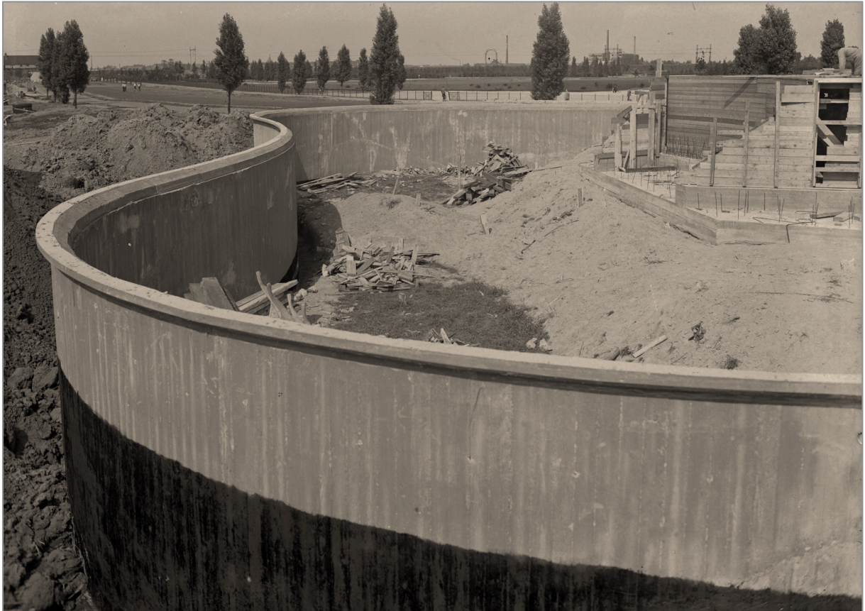
Ruwbouw van de betonnen perkrand, met rechts dienstruimten in aanbouw, medio 1939 (Foto Gerrit Burg/HNI)
