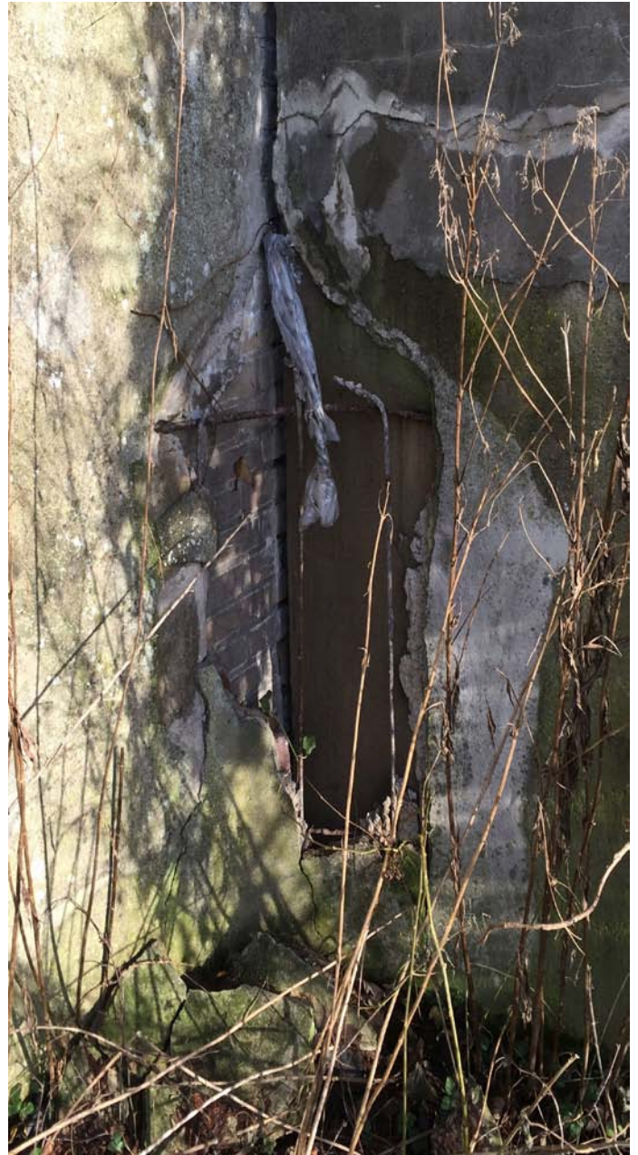
nr: 15 toelichting: Schade in hoek plaats: overgang keerwand achterwand
