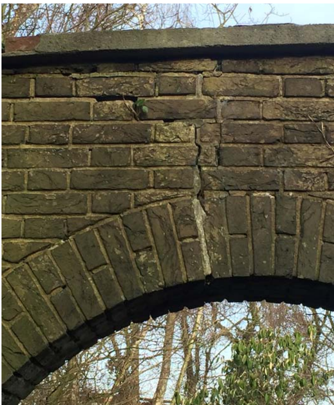
nr: 14 toelichting: scheur en afchuiving in metselwerk plaats: detail boven poort
