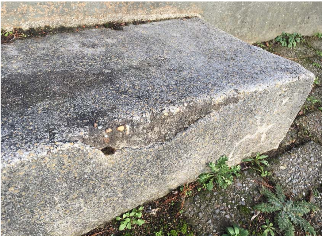
nr: 20 toelichting: detail sierpleister vermoedelijk originele bloktrede plaats: midden keerwand
