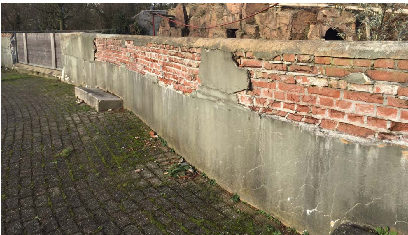
nr: 17 toelichting: Veel scheuren, schade en onthechting in metselwerk ophoging keerwand plaats: Keerwand
