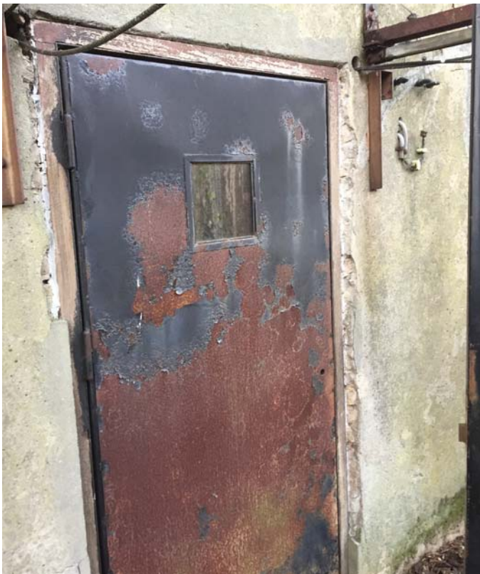
nr: 23 toelichting: Roest op deur (niet origineel) plaats: voorzijde achterwand
