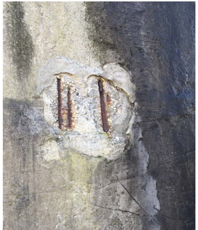
nr: 26 toelichting: Roestende wapening in beton plaats: Rots achterzijde
