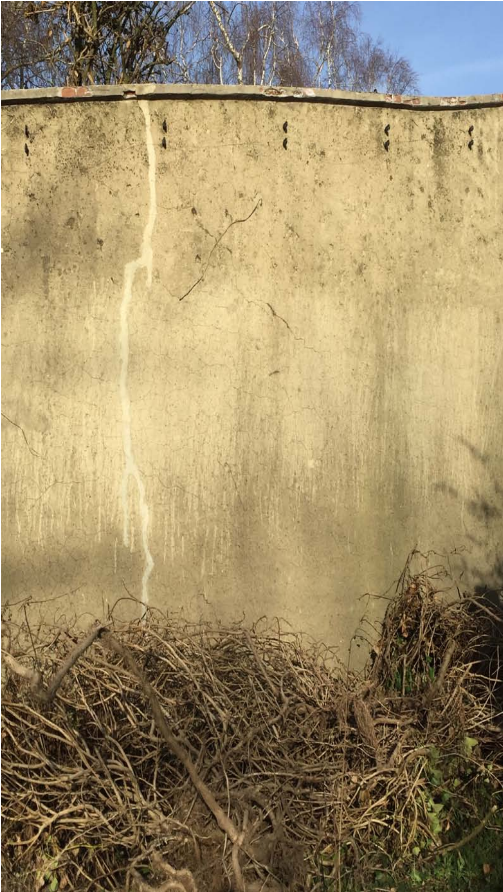
nr: 16 toelichting: Veel scheuren en craquele in pleisterlaag plaats: Voorzijde achterwand
