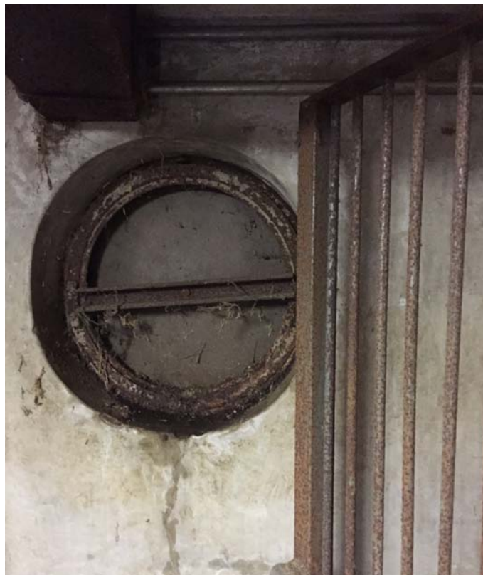
nr: 31 toelichting: origineel raam geroest plaats: Interieur dierenverblijf
