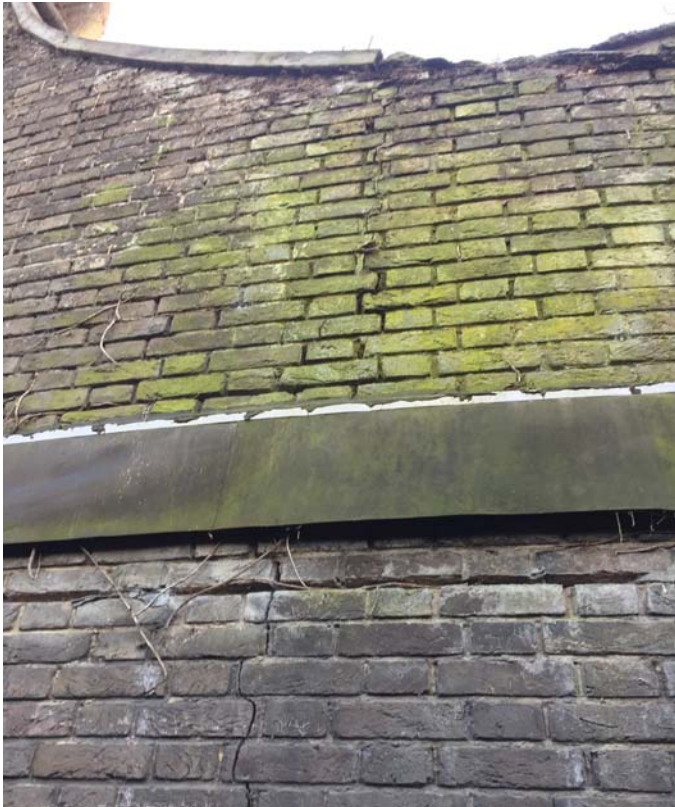
nr: 39 toelichting: Verticale scheur top tot voet plaats: Achterwand achterzijde
