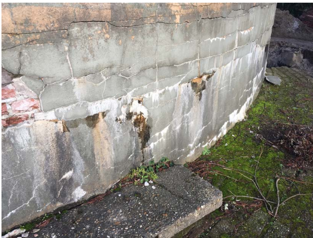
nr: 18 toelichting: Veel scheuren en craquele met uitbloeiing in pleisterlaag op beton plaats: Keerwand
