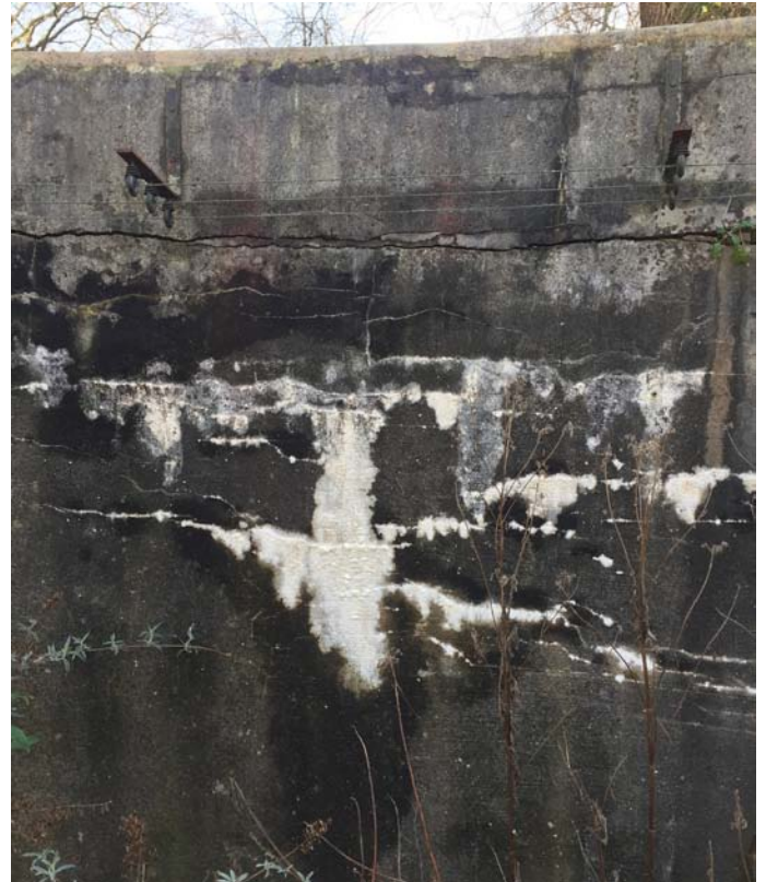
nr: 22 toelichting: scheur en craquele met uitbloei plaats: binnenzijde keerwand
