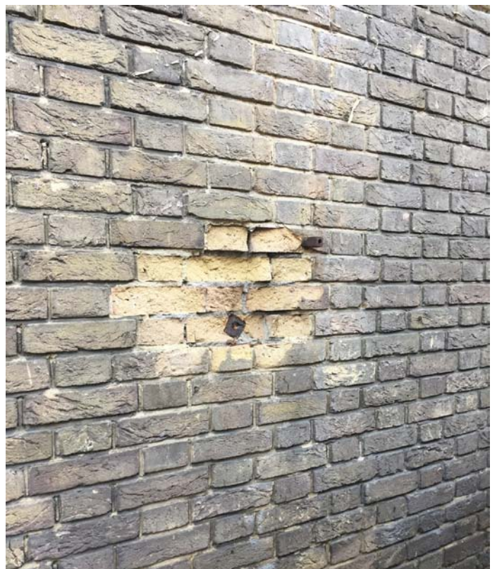
nr: 38 toelichting: Schade aan metselwerk plaats: Achterwand achterzijde
