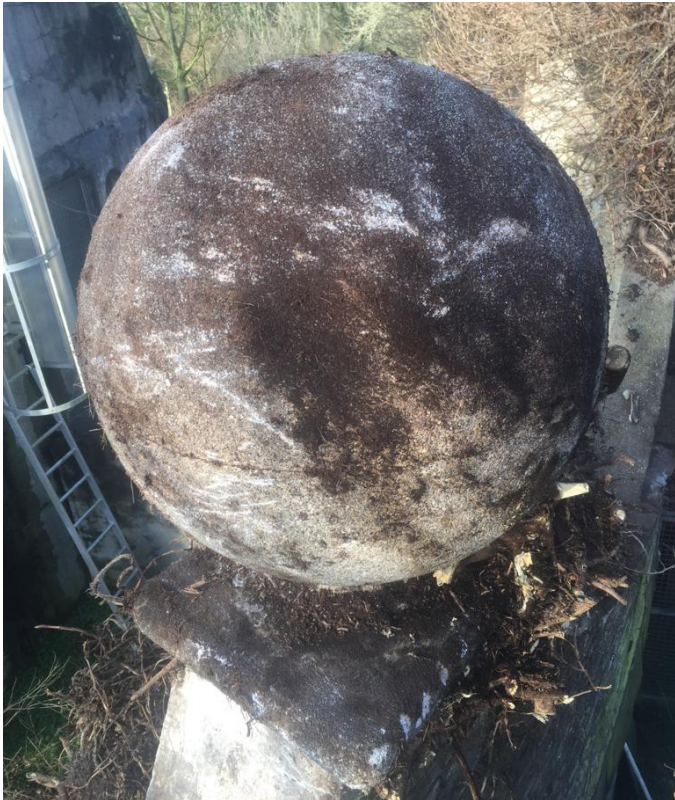
nr: 9 toelichting: vervuiling bol plaats: ornament achterwand
