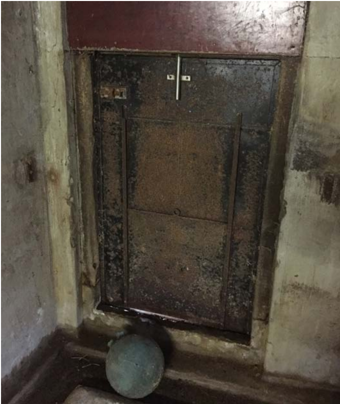
nr: 29 toelichting: Deuren gerost (niet origineel) plaats: Interieur dierenverblijf
