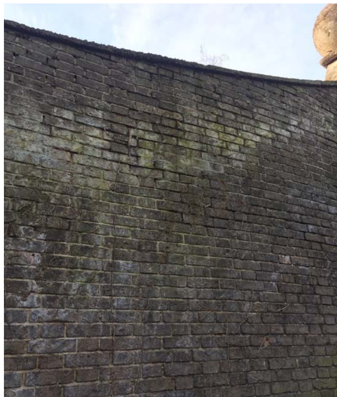
nr: 37 toelichting: Schade aan metselwerk en voegwerk door klimop plaats: Achterwand achterzijde
