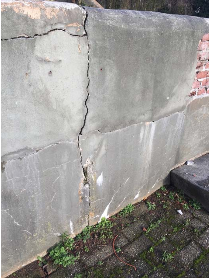
nr: 19 toelichting: door en door scheur in metselwerk en beton plaats: midden keerwand
