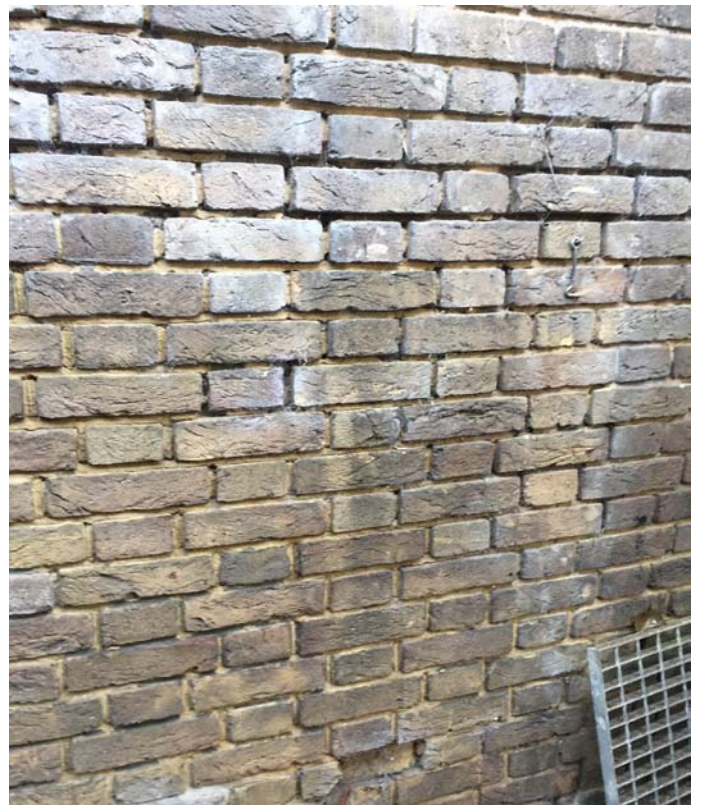
nr: 42 toelichting: Veel voegwerk (snijvoeg) uitgespoeld plaats: Achterwand achterzijde
