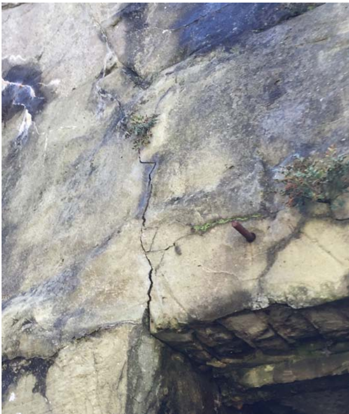
nr: 25 toelichting: Grootschalig scheurvorming plaats: Rots rondom
