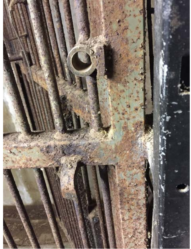
nr: 34 toelichting: vermoed. origineel hek geroest plaats: Interieur dierenverblijf
