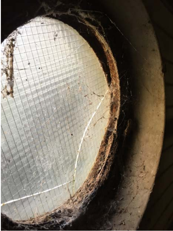
nr: 33 toelichting: origineel raam geroest plaats: Interieur dierenverblijf
