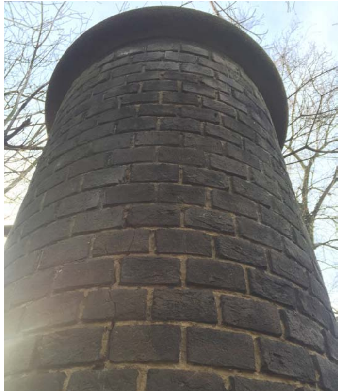
nr: 36 toelichting: Verticale scheur plaats: Kolom links achterwand achterzijde
