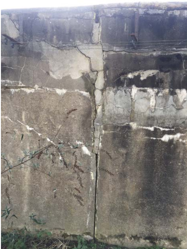
nr: 21 toelichting: scheur keerwand plaats: binnenzijde keerwand
