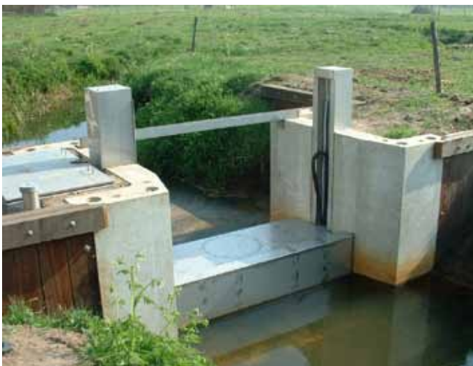
Figuur 4.2 | Venturi-meetdoorlaat in Strijbeekse Beek als meest stroomopwaartse trede van een bekkervispassage.
