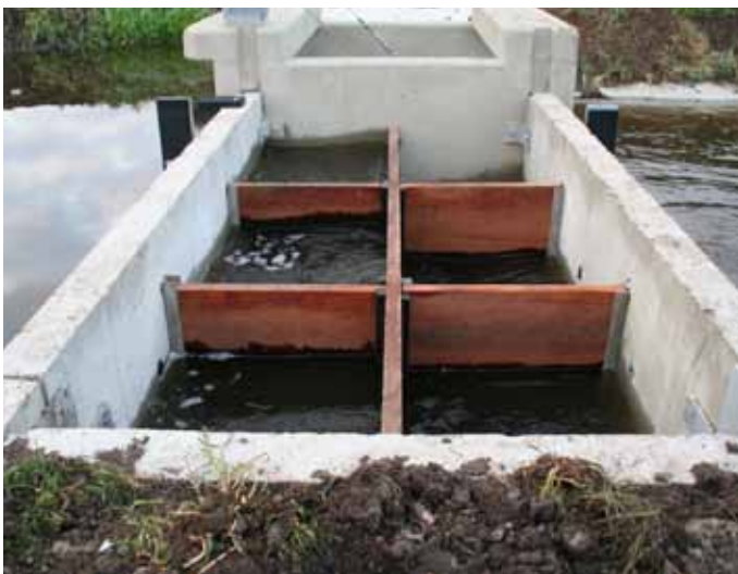
Figuur 16.1 | Schutte-vispassage met zes kamers, ingeklemd tussen de keerwanden van de stuw. Foto: waterschap Groot Salland
