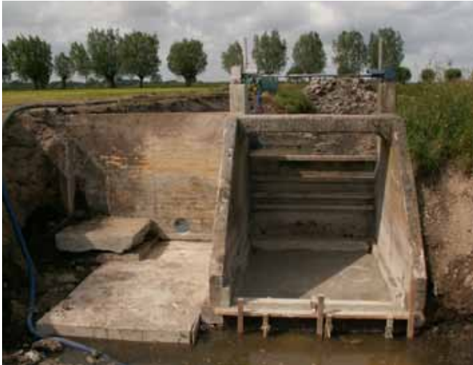
Figuur 13.2 | Aanleg van een De Wit-vispassage bij stuw Biggelaar in de Kleine Beek, met het gat in de vleugelfundering van de stuw.
