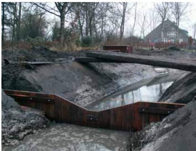
Figuur 10.3 | Specifieke aanpassingen in het drempelontwerp zorgen ervoor dat deze ook vispasseerbaar zijn bij lage afvoeren: een steile(re) helling met een vlak centraal deel.
