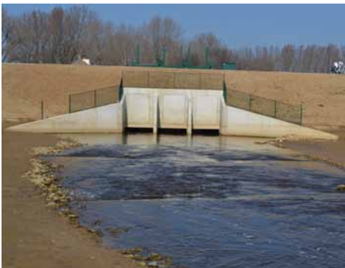
Figuur 10.27 | De constructie van de uitstroomopening in de primaire kering van de bekkervispassage bij Crèvecoeur.
