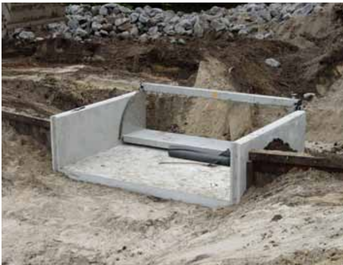
Figuur 10.21 | Klep in de vispassage Zaartpark in de Aa of Weerij, bedoeld om in droge perioden water vast te houden.
