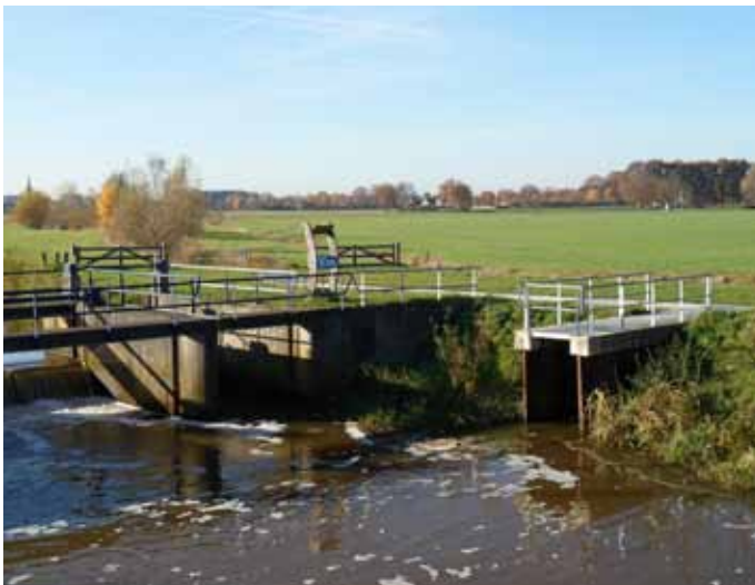
Figuur 5.3 | Vertical slot vispassage die op gevaarlijke plekken is voorzien van een reling.
