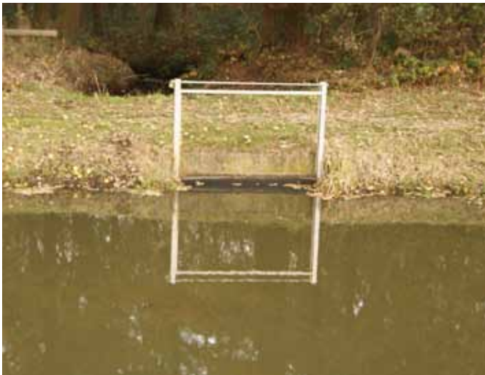
Figuur 9.2 | Met schotbalken afsluitbare inlaat van een traploze nevenbeek in de Reusel bij Diessen.
