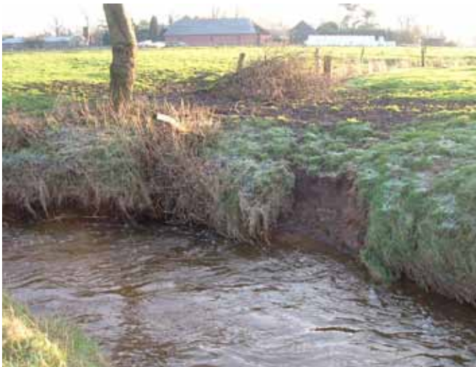
Figuur 10.16 | Oevererosie door onjuiste plaatsing van een drempel.
