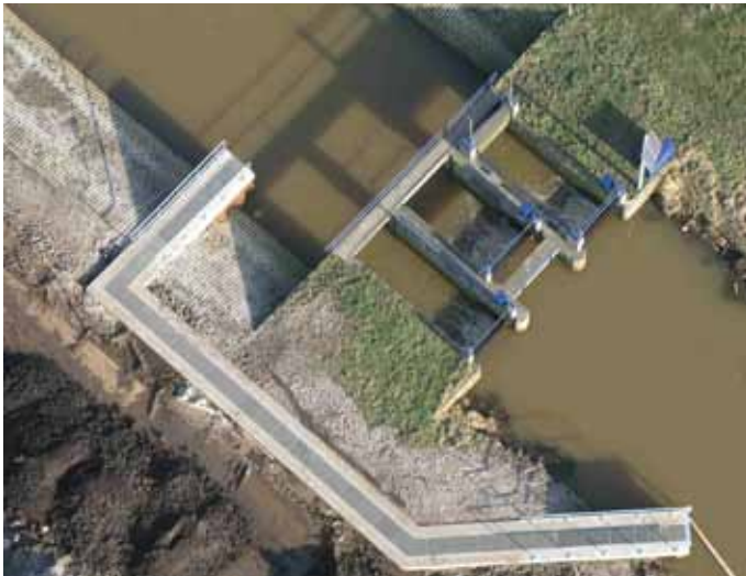
Figuur 12.2 | Vertical slot vispassage Bakkebrug in de Aa of Weerij. Van bovenaf gezien ligt de vispassage (bij benadering) in een U-vorm, zodat geen duikers nodig zijn voor de verbinding met de waterloop; stroomafwaarts staat de vispassage haaks op de beek, zodat de lokstroom de grootste aantrekkingskracht heeft.
