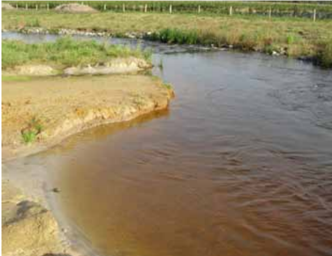
Figuur 10.10 | Oevererosie, uiteindelijk leidend tot achterloopsheid en vorming van een kortsluiting bij de drempel van een bekkervispassage die is aangelegd op een zeer zandige bodem.
