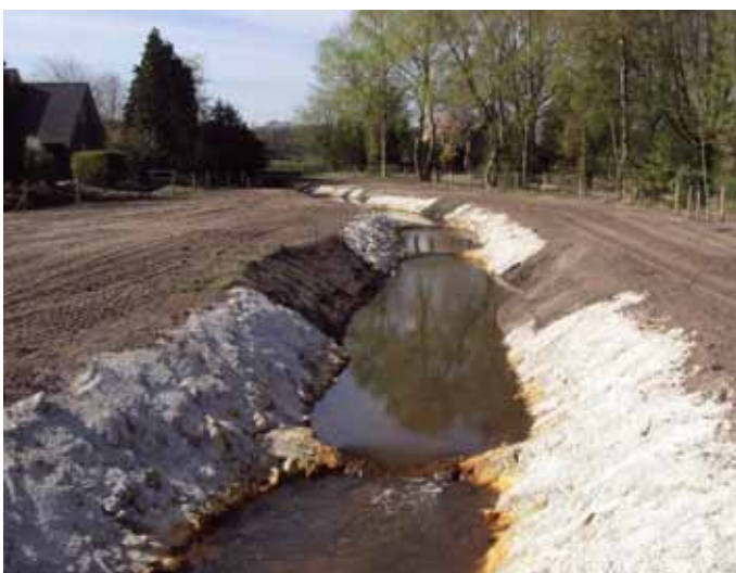
Figuur 10.18 | Later zijn aanvullend tegen het talud van vispassage Galderse Beek stortstenen en beton aangebracht, waarbij het beton over de stenen is gestort en er een ongewenste situatie is ontstaan.
