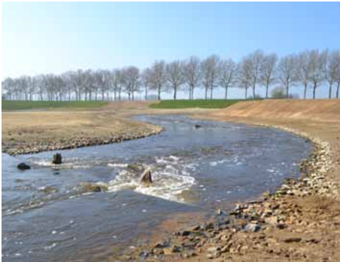
Figuur 10.26 | Impressie van de bekkervispassage bij Crèvecoeur direct na oplevering in maart 2012: één van de 22 drempels met stoorstenen.
