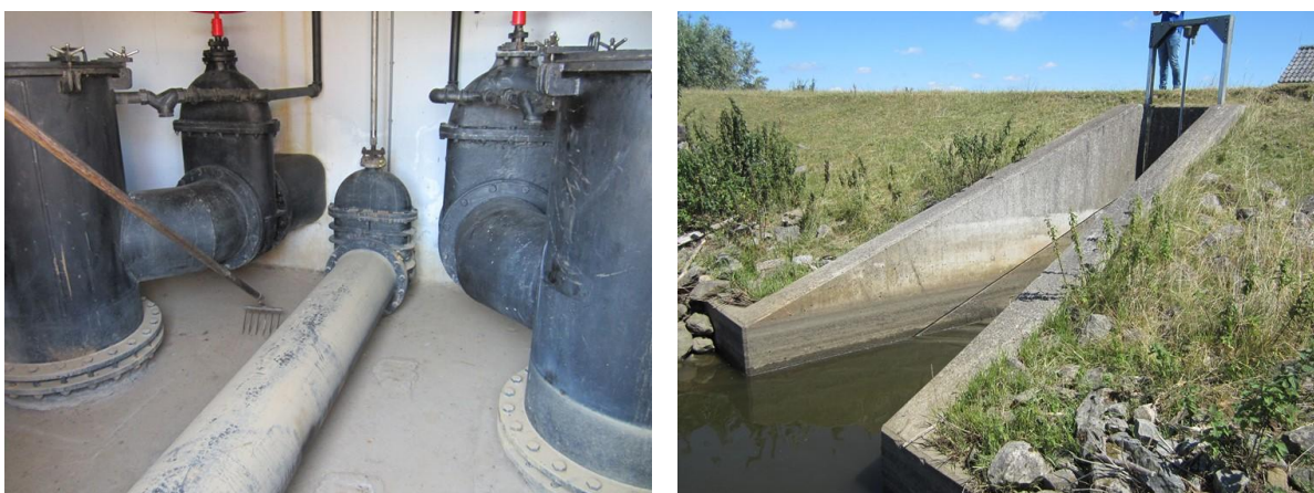
Figuur 14 Links: Inlaatleiding; Rechts: Uitstroomconstructie
