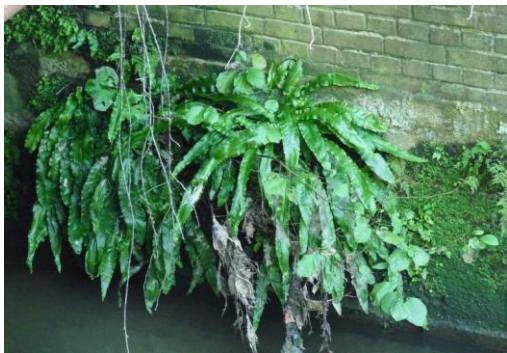
Foto 7. Tongvarens op een kademuur van de aftakking van de Geul, onder het gebouw door.
