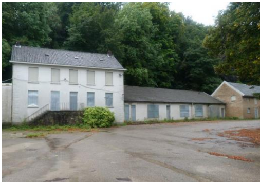
Fig. 24. Gebouw 5, 4 en 3 van links naar rechts. Bij deze gebouwen vindt dakrenovatie plaats.
