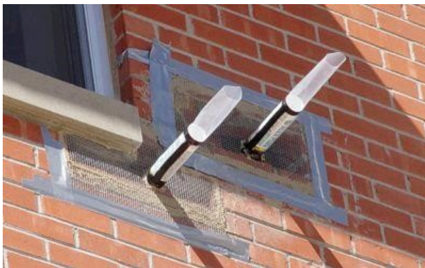
Afbeelding 1: voorbeeld van een methode zodat vleermuizen wel naar buiten kunnen komen maar niet terug kunnen vliegen de spouwmuur in (©Richard Witte).
