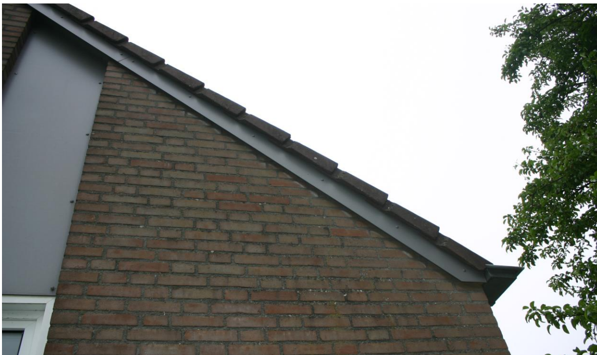
Figuur 4.2. Onder de gevelpannen zit een gladde, trespa plaat. Onder de trespa plaat is een houten lat bevestigd, die de toegang tot de spouw ontzegt.
