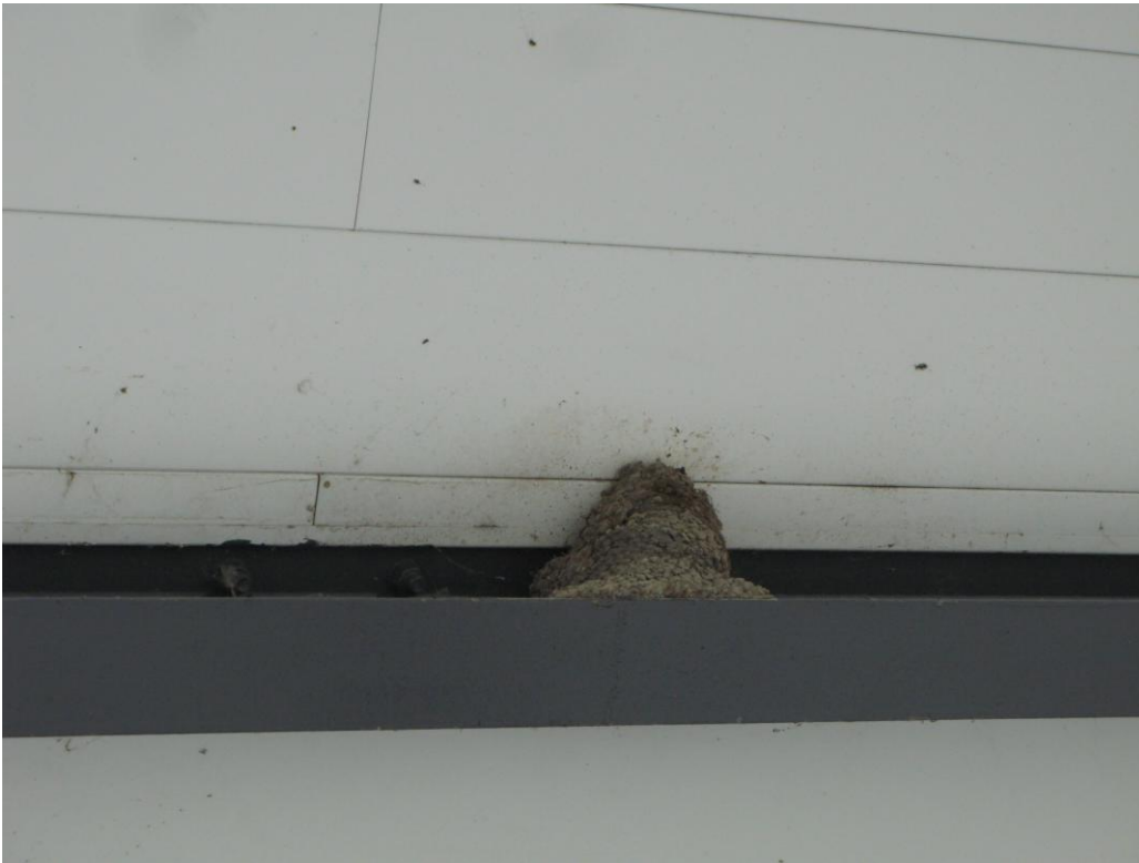
Foto 1: nest van (waarschijnlijk) de Huiszwaluw onder het dak van het gemaal.
