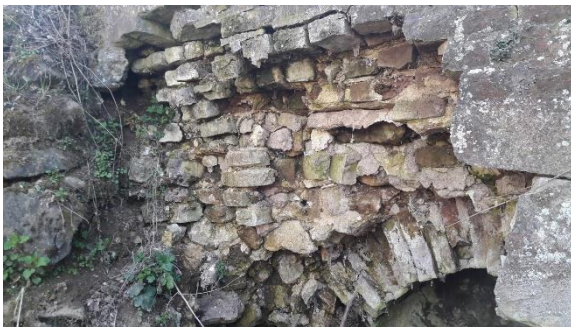
Duiker Putsweg te Eys – KW33 Aan 1 zijde van de duiker is de metselwerk keerwand bezweken. In 2020 wordt de keerwand vervangen om uitspoeling van bovenliggende rijbaan te voorkomen.
