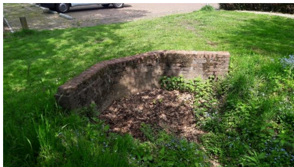
Duiker Malleziep te Mechelen– KW68 De duiker is volledig vervuild met bladeren en slib. Geadviseerd wordt de functie van de duiker te herstellen door deze in 2020 door te spuiten.
