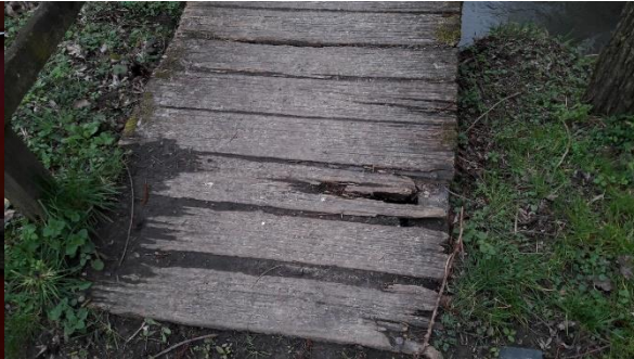
Houten brug Grote Bosweg te Beutenaken – KW05 Aanzienlijke houtrot in diverse houten onderdelen van de brug. Zowel de gebruiksveiligheid als de conditie van de brug zijn als slecht beoordeeld.
