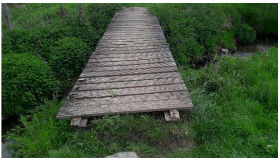
Houten brug Cartilservoetpad te Eys – KW44 De brug ligt scheef en schuif van zijn oplegging af. Een aantal dekplanken zit los. Geadviseerd wordt in 2020 een degelijke oplegconstructie aan te brengen en de losse dekplanken vast te zetten.
