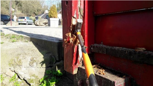
Houten brug Slenakerpad te Slenaken – KW02 Aanzienlijke houtrot in diverse houten onderdelen van de brug. De gebruiksveiligheid van de brug zijn als slecht beoordeeld, de algehele conditie als redelijk.
