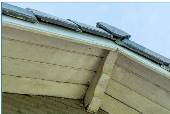
Openstaande kantpannen en spleet tussen overstek en muur geeft toegang tot ruimtes voor gebouwbewonende vleermuizen.
