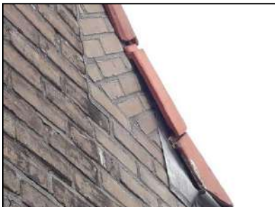
Figuur 6. Ruimten tussen de kantpannen en het metselwerk van een woning op de onderzoekslocatie.
