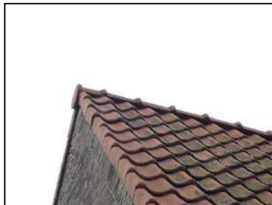
Figuur 7. Ruimten tussen de nokpannen en de dakpannen van een woning op de onderzoekslocatie.
