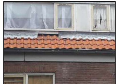
Figuur 8. Ruimte tussen de dakpannen en de dakkapel door een ontbrekende loodflap op een van de woningen.
