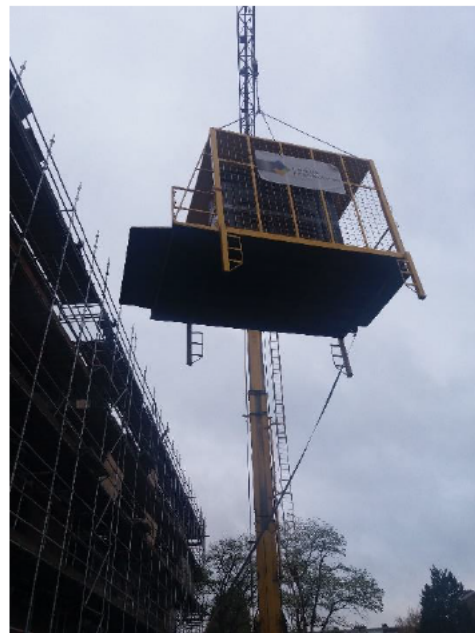
Per portiek wordt de werkruimte per kraan opgehesen. Daarna wordt de werkruimte voor de kraan neergezet.
