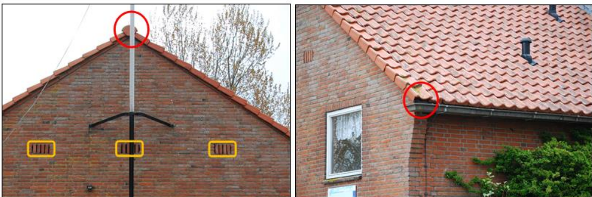
Figuur 5.1. Links: Nokpan die geschikt zou zijn als broedplek (rood) voor de gierzwaluw en de open stootvoegen geschikt voor vleermuizen om te gebruiken (geel). Rechts: Dakpannen die geschikt zijn voor huismussen om onder te nestelen (rood).
