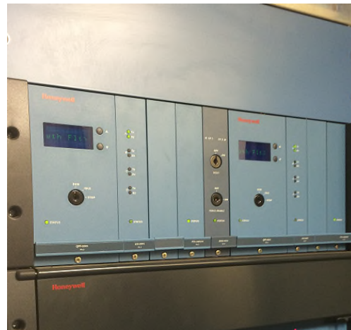
Honeywell ESD systeem
