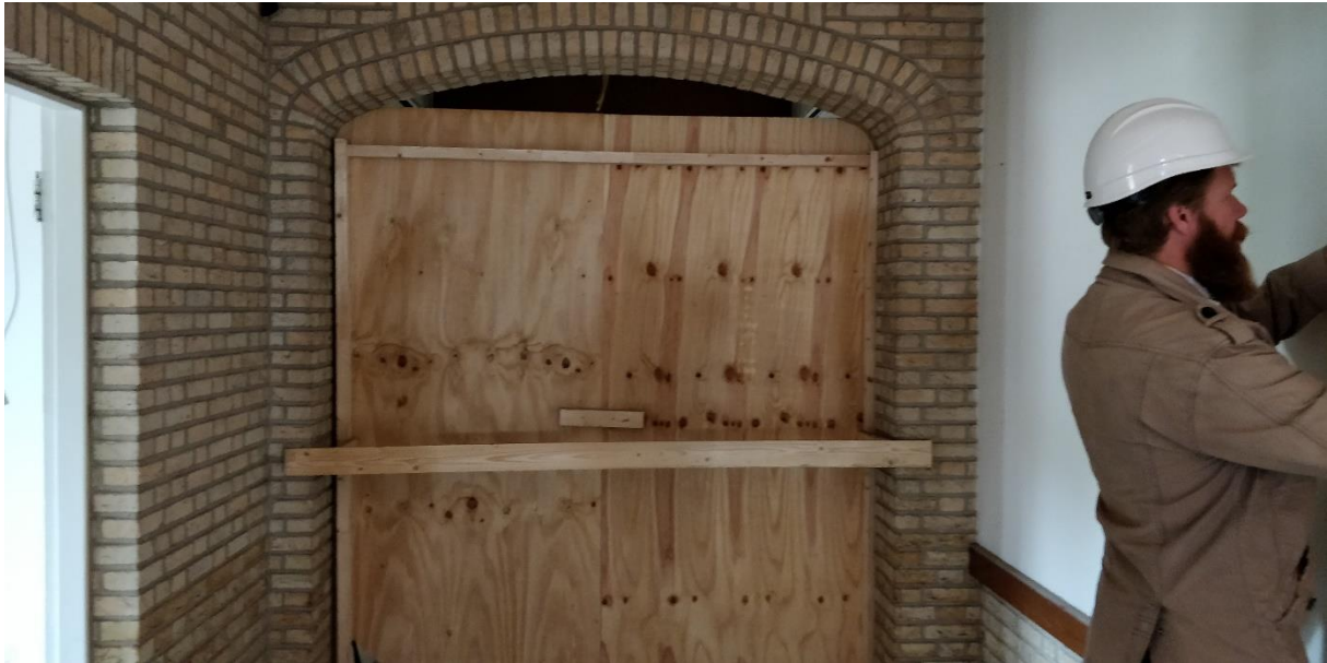
Foto 23: Andere kant van punt 16. Dichtgezette boog van metselwerk.
