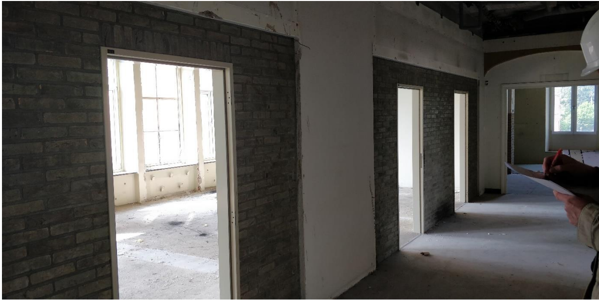
Foto 61: Bogenstructuur blijft zoveel mogelijk behouden
