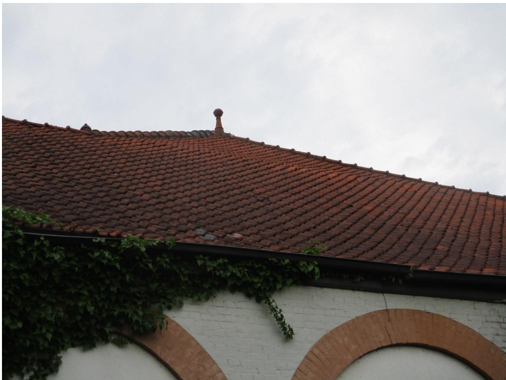
Figuur 4 De dakpannen liggen recht, waardoor hier geen invliegopeningen aanwezig zijn.
