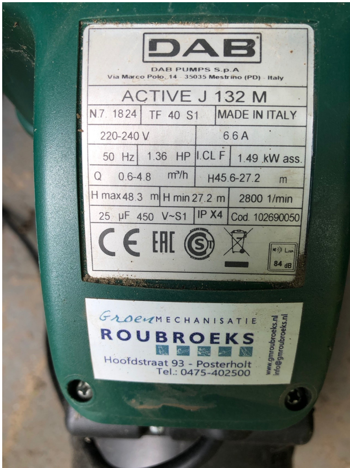
Bijlage 3: foto van het pompplaatje
