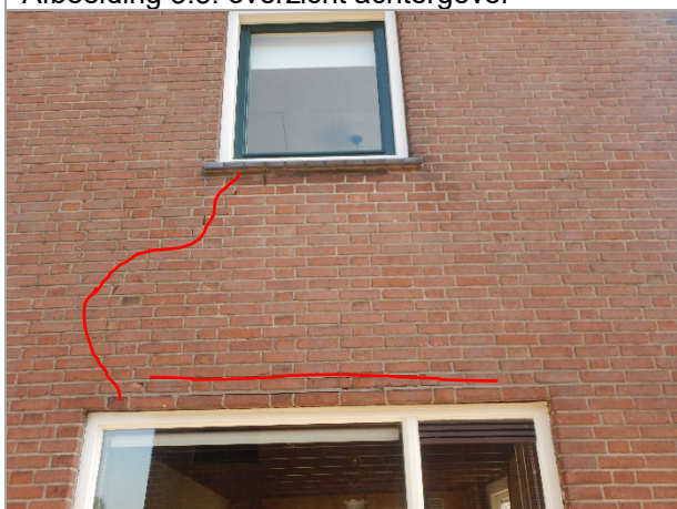
Afbeelding 5.5: scheuren boven rechterraam
