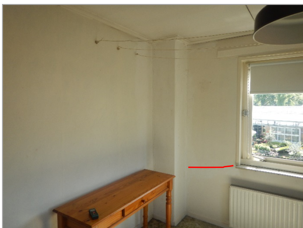
Afbeelding 5.9: scheur linker bouwmuur
