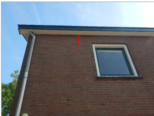
Afbeelding 5.7: scheur naast linkerraam
