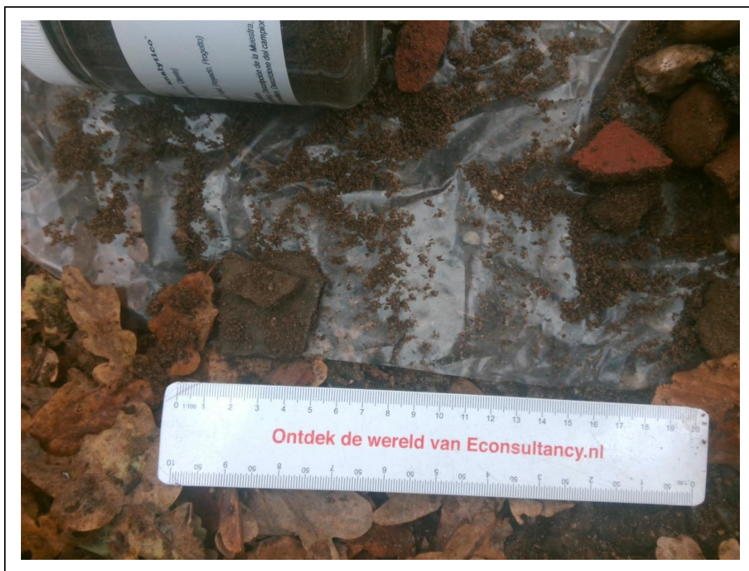
Foto 3. Asbestverdacht materiaal asbestinspectiegat G03
