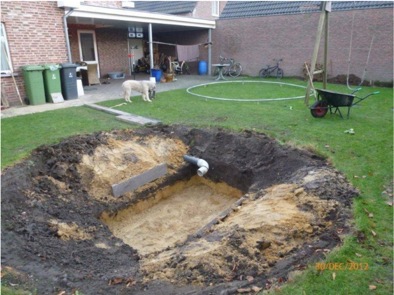
Afbeelding 4.19: Opvangen en infiltreren van hemelwater (bron: gemeente Bergeijk)
