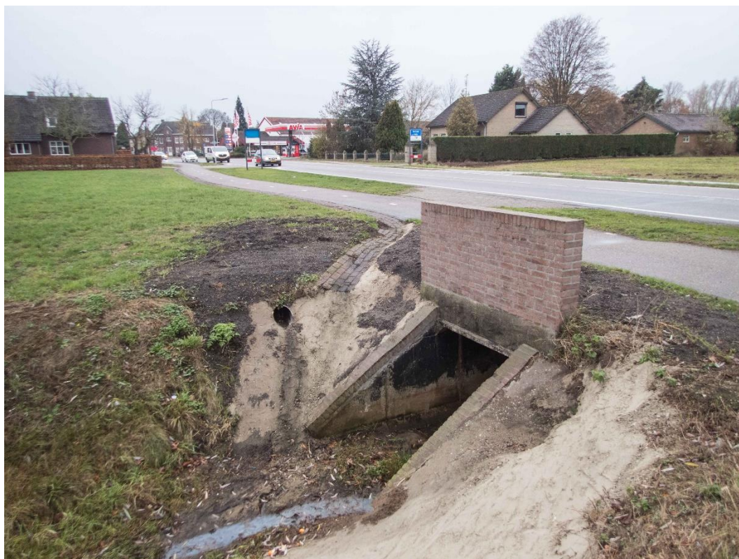
Figuur 9: Voorbeeld van een afwateringsgoot, die uitmondt in de Kwistbeek
