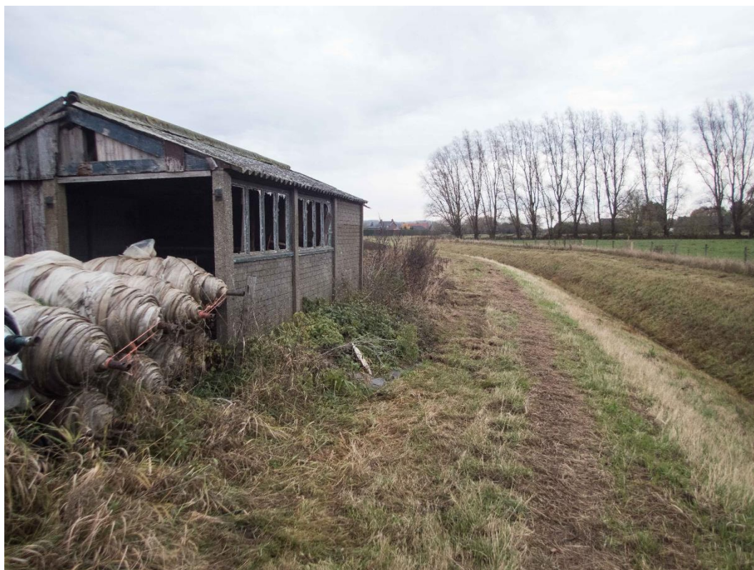
Figuur 8: Voorbeeld van een asbestverdacht dak (links) nabij de Kwistbeek (rechts)
